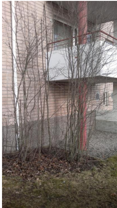
Kuva 5. Pensas kasvaa liian suurena, peittää parvekkeita ja on ränsistynyt
