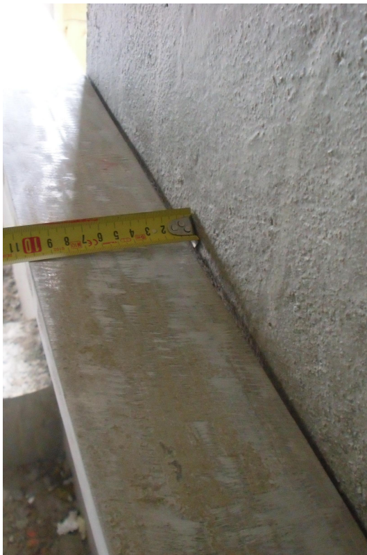
Kuva 6. Betonielementin pinnan epätasaisuus [Vili Rinne]
