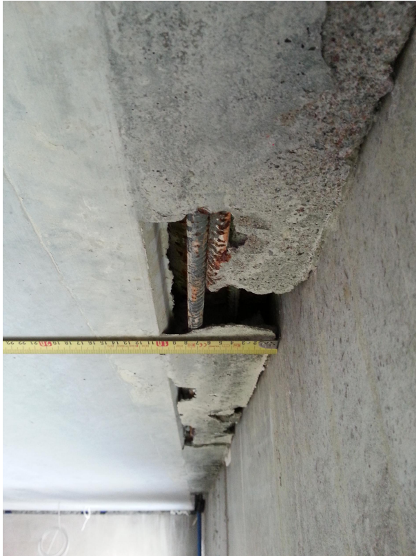
Kuva 15. Ontelolaatan ja seinäelementin välinen valukaista, jossa betonin tiivistäminen on epäonnistunut [Vili Rinne]
