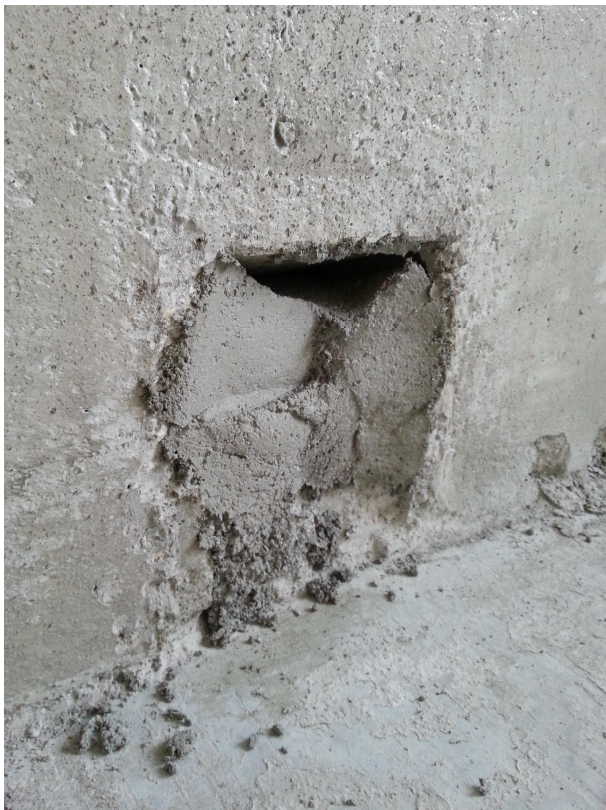
Kuva 13. Epäonnistunut tartuntavarauksen täyttö [Vili Rinne]
