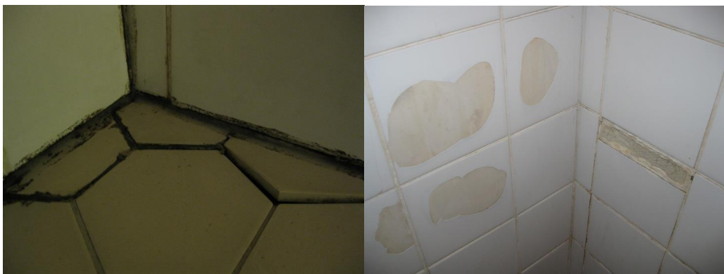
Kuvio 17. Vasemmalla lattialaatta on irti pohjasta, oikealla rikkoontunut laatta
