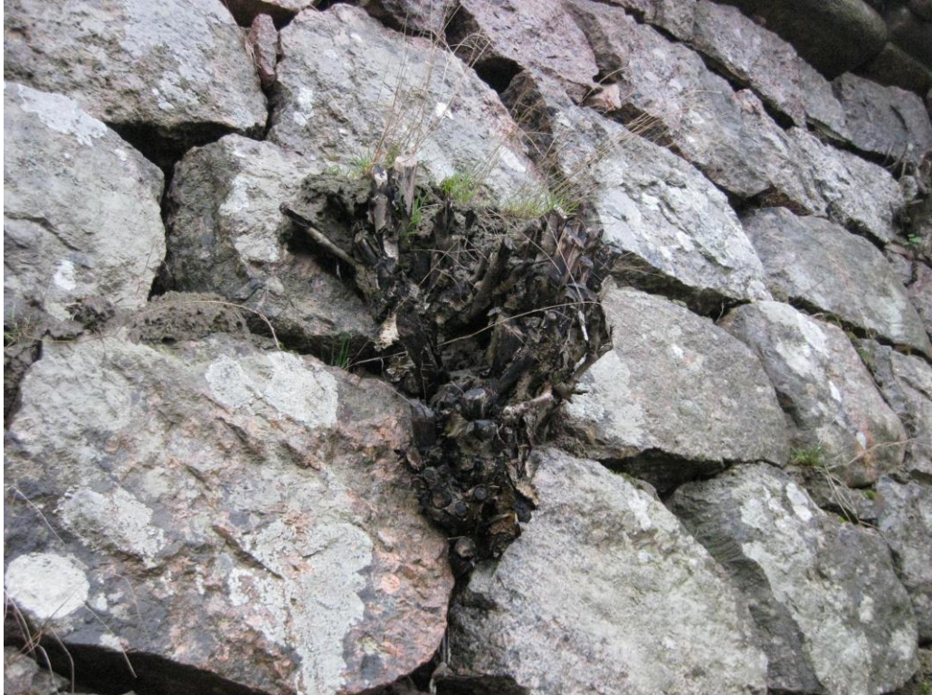
Kuva 7. Muurin rakosesta tunkeutunutta koivua ei voida poistaa, sillä se tukee rakennuskiviä.
