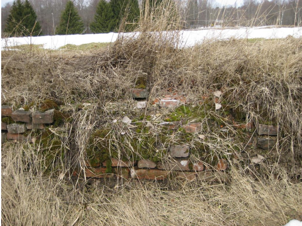
Kuva 27. Kunnostamaton rintamuurin osa on vaurioitunut pahoin.
