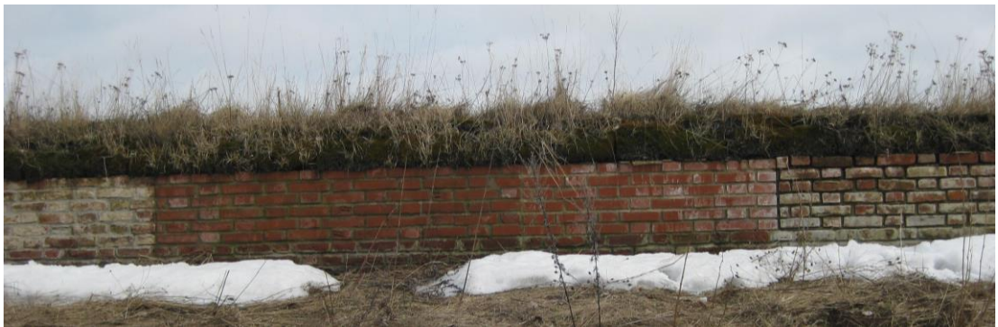
Kuva 22. Kuvassa näkyy tiilimuurikokeen kunto vuonna 2013.
