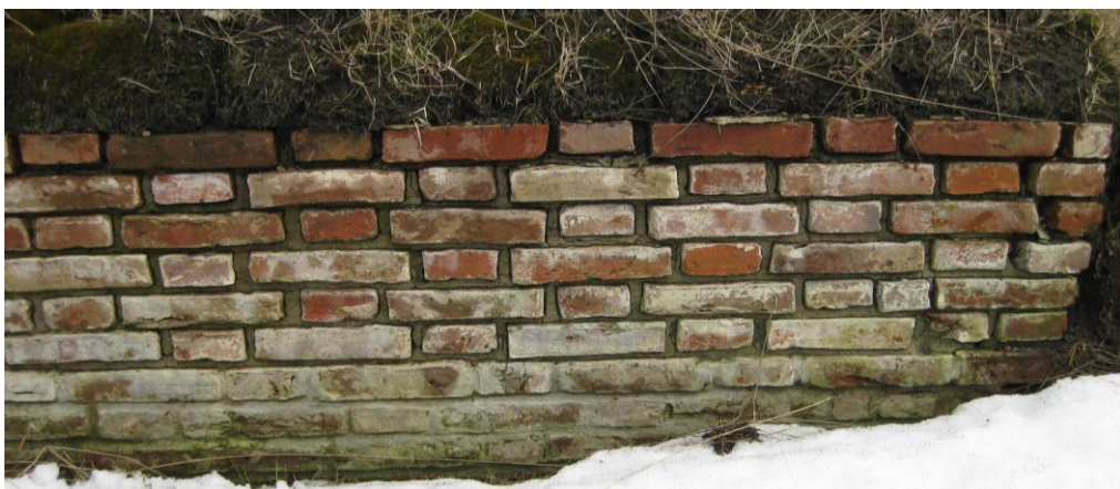
Kuva 26. KS90/10(K100)-kalkkilaasti vaurioitui pahoin viiden vuoden aikana.
