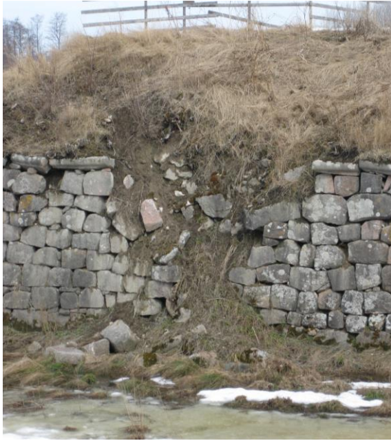
Kuva 12. Päämuurissa on useissa kohdin pahoja sortumia. Tämä sortuma sijaitsee bastioni yhdessä.
