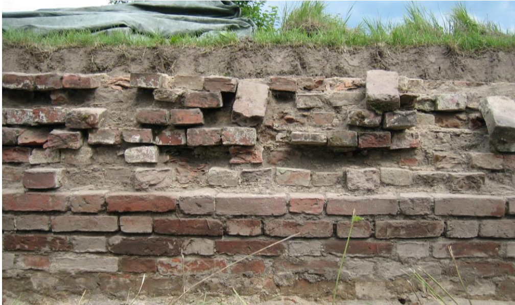
Kuva 20. Puhdistetun rintamuurin yläosa on pahoin vaurioitunut. (Valtonen 2008:9.)
