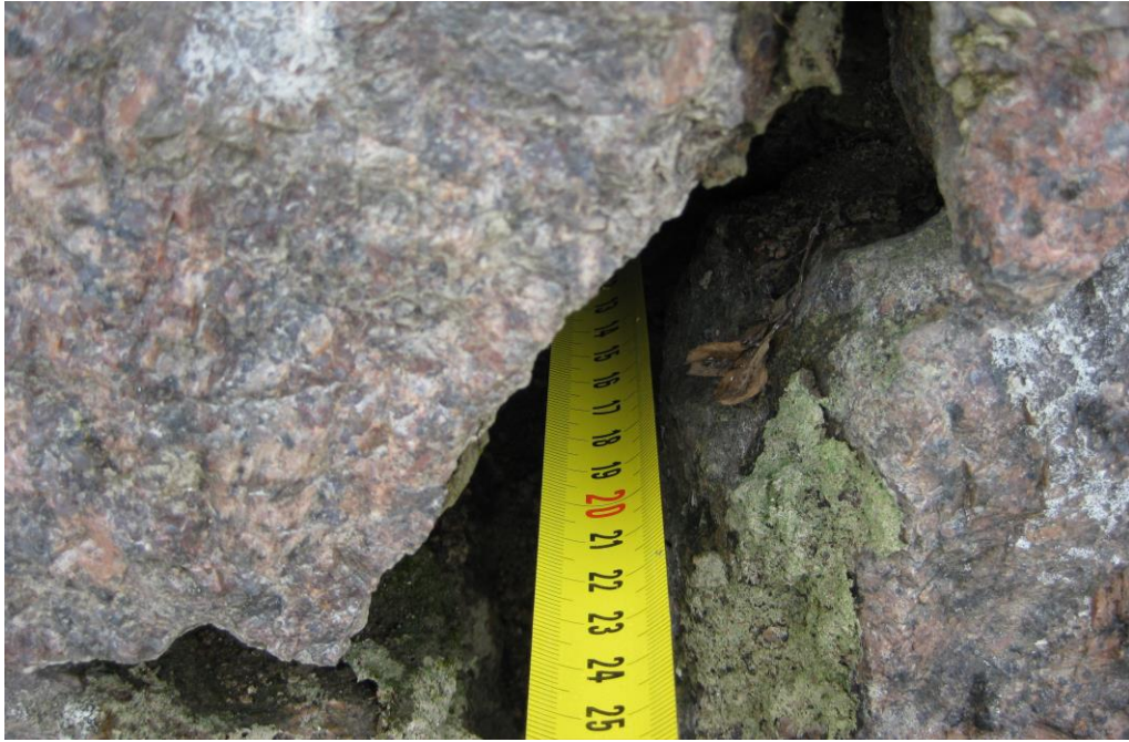
Kuva 16. Eroosio ja routiminen ovat irrottaneet kiilakivet ja laastin ainakin 20 - 50cm syvyyteen asti. Työmenetelmänä käytettiin fotogrammistia dokumentointia.
