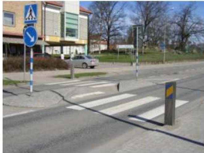
Kuva 27. Keskisaareke jalankulkijan huomiota herättävällä odotustilalla on sijoitettu tielle, vaikka ajokaistoja on vain yksi suuntaansa. [61]
