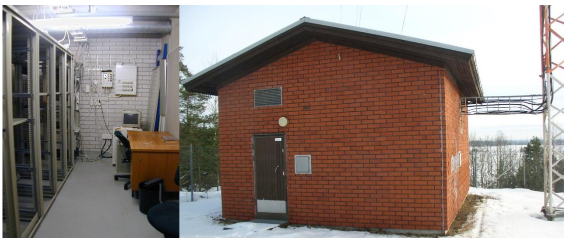
KUVA 29. Tyypillinen liityntäverkon laitetila/jakamo sisältä ja ulkoa (7)
