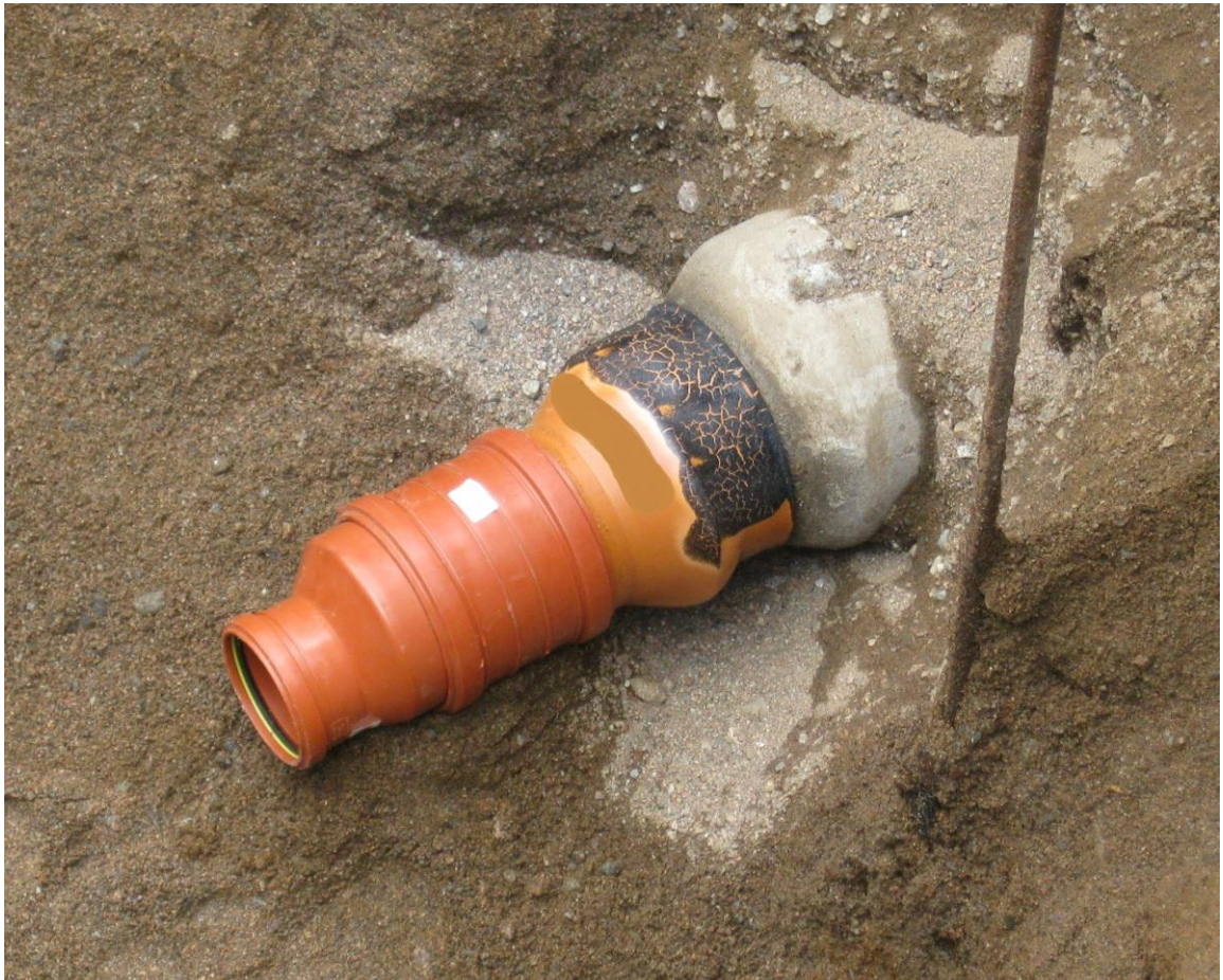
KUVA 15: Betoni-PVC jatkoyhde väärin asennettuna.
