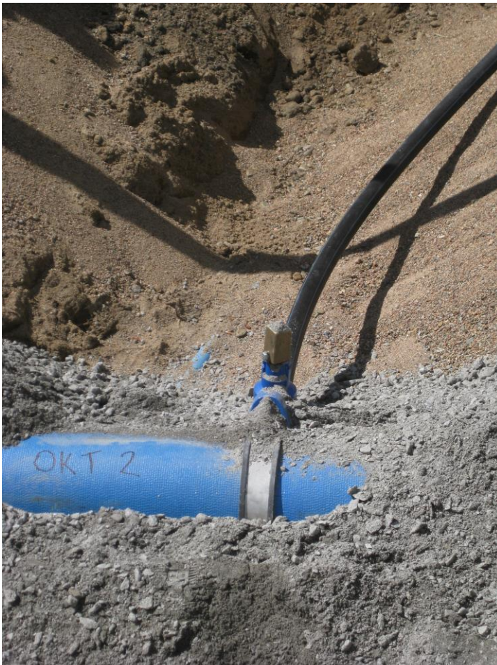
KUVA 8: Uusi vesijohdon haaraventtiili SG-paineputkessa.
