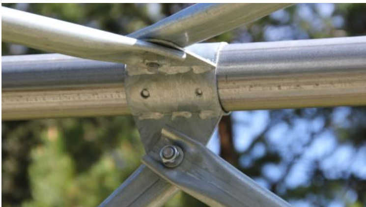
KUVA 19. Diagonaaliholkki opinnäytetyön tilaajan mastossa
