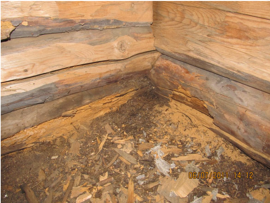
KUVA 11. Epätiiveyskohta yläpohjan lämmöneristeessä on aiheuttanut hirsien lahoamisen
