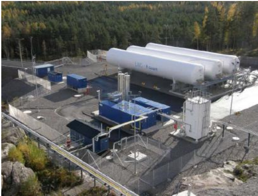
Kuva 5. Kilpilahden LNG-laitos (Gasum)
