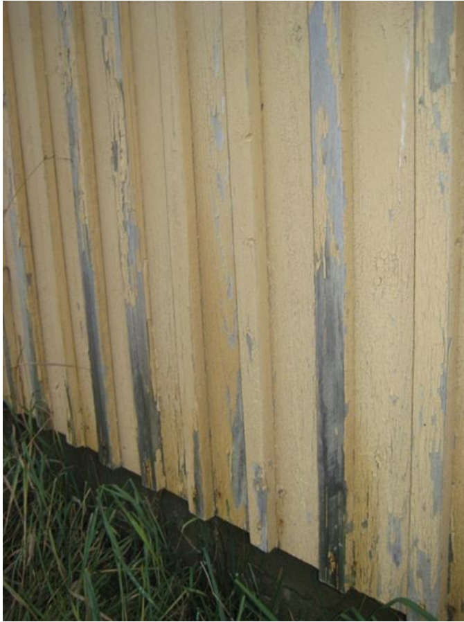
Kuva 8. Julkisivuverhouksen vaurioitunut maalipinta. Kuva: Ossi Kauppinen 2012.
