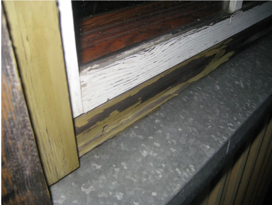
Kuva 12. Maalivaurioita kärsinyt ikkunanpieli. Kuva: Ossi Kauppinen 2012.
