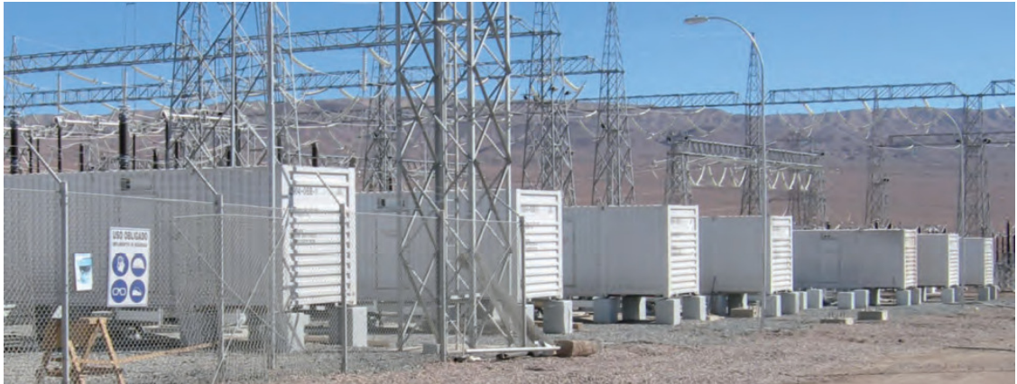
Kuva 4. Chilessä oleva 3 MWh:n litiumioni-akusto [11, s. 44 ]
