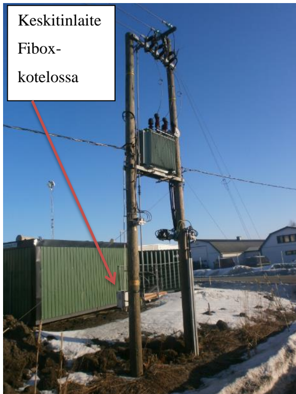
Kuva 4. Keskitinlaite asennettuna pylväsmuuntamolle
