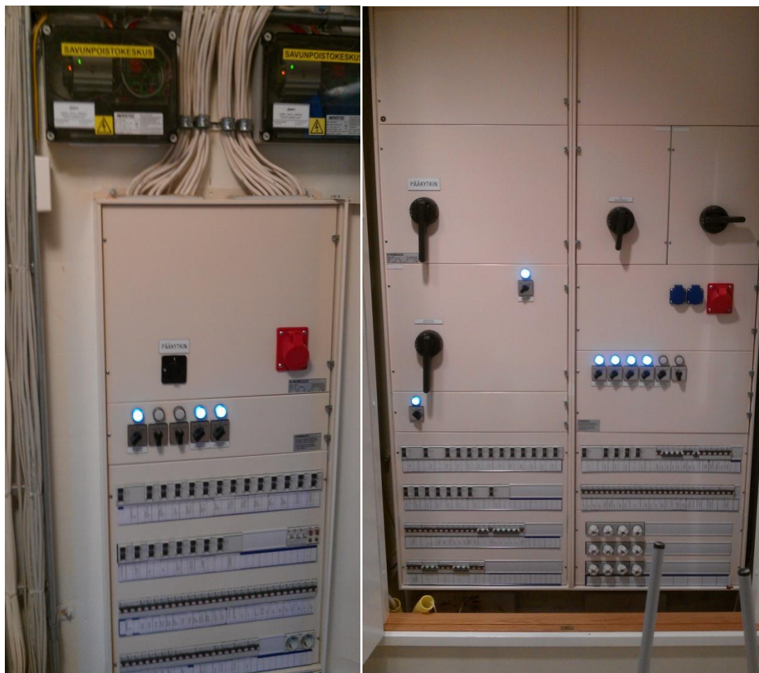
Kuva 4. ;sähkökeskusten kaapeli ja johdinmerkinnät puuttuivat; Pääkytkimen koko tai väri ovat identtiset muihin verrattuna sekä pistorasioiden sijoittelu on ongelmallinen
