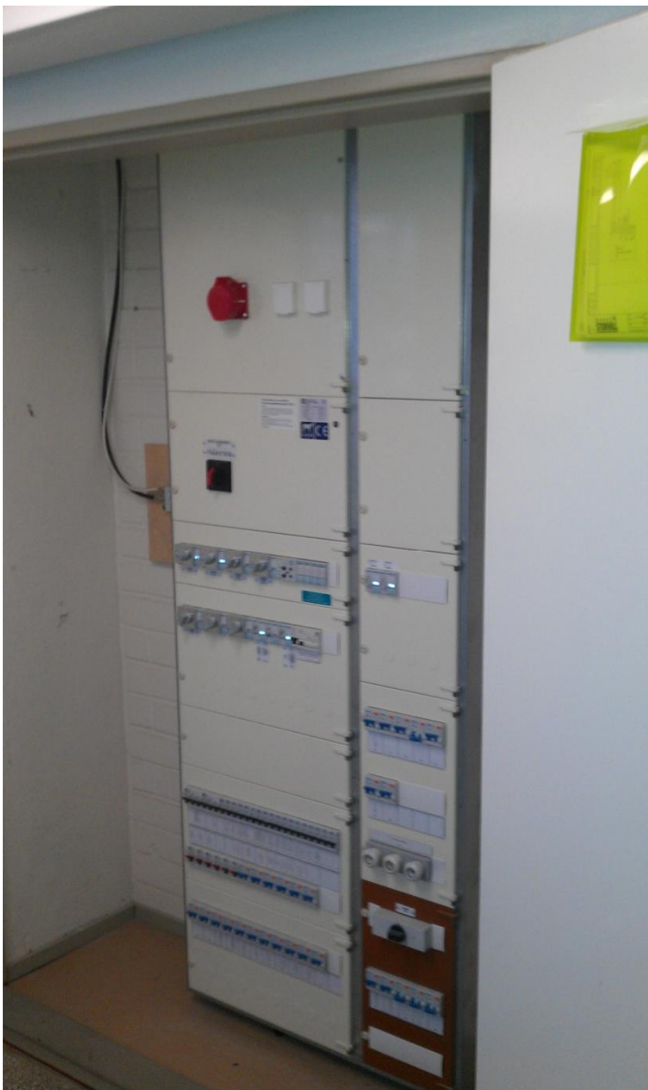
Kuva 5. Sähkökeskus; keskuksen komero liian matala; keskuksen luokkuja ei saada auki
