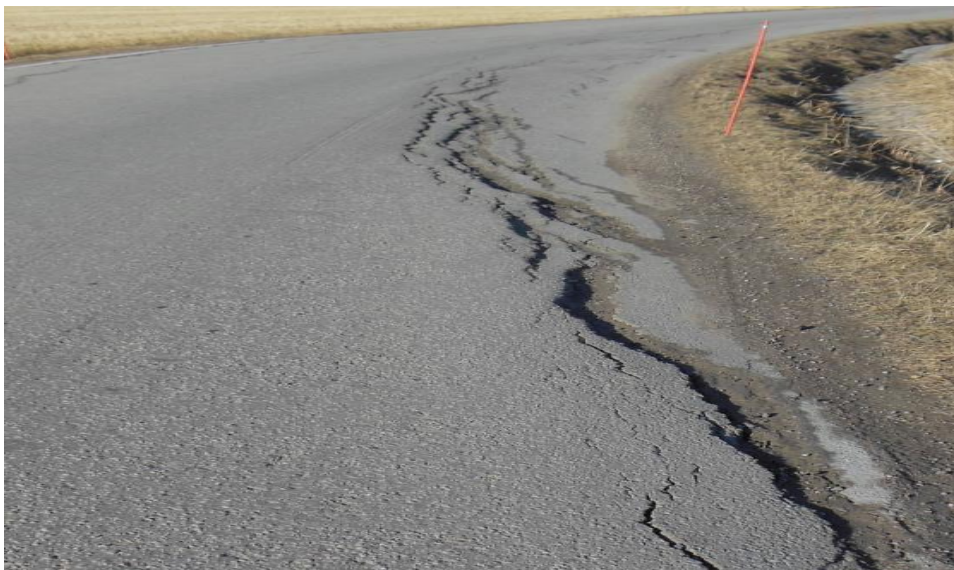
KUVA 15. Pituussuuntainen routahalkeama (Kuva: Juha Poskiparta 2013).
