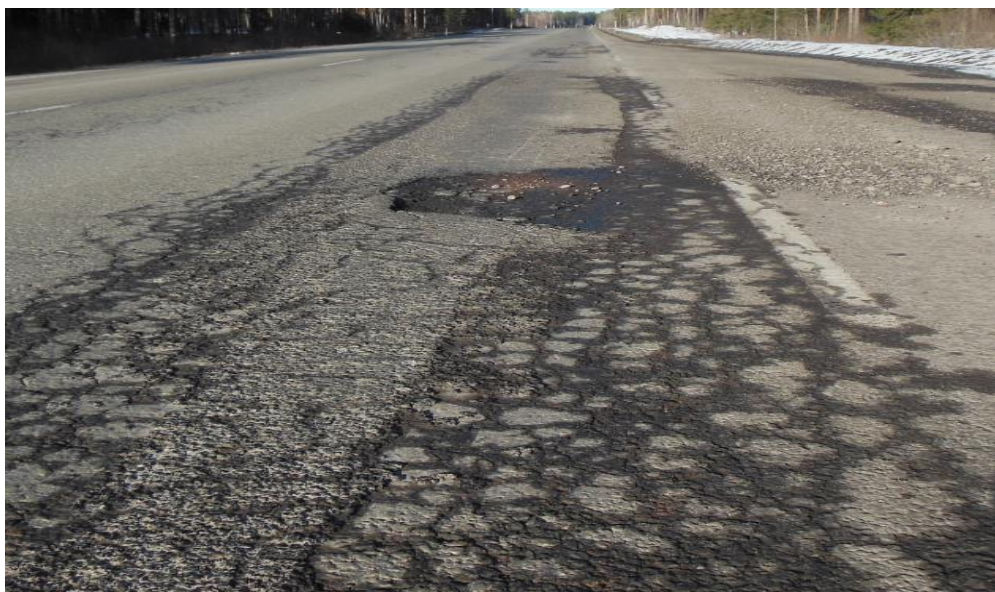
KUVA 20. Pahasti vaurioitunut kantatien pinta (Kuva: Juha Poskiparta 2013).
