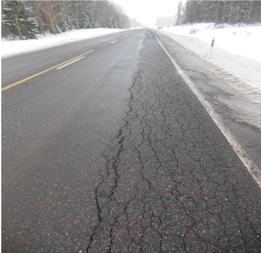
KUVA 8. AB-päälysteen verkkohalkeamia (Kuva: Juha Poskiparta 2013).
