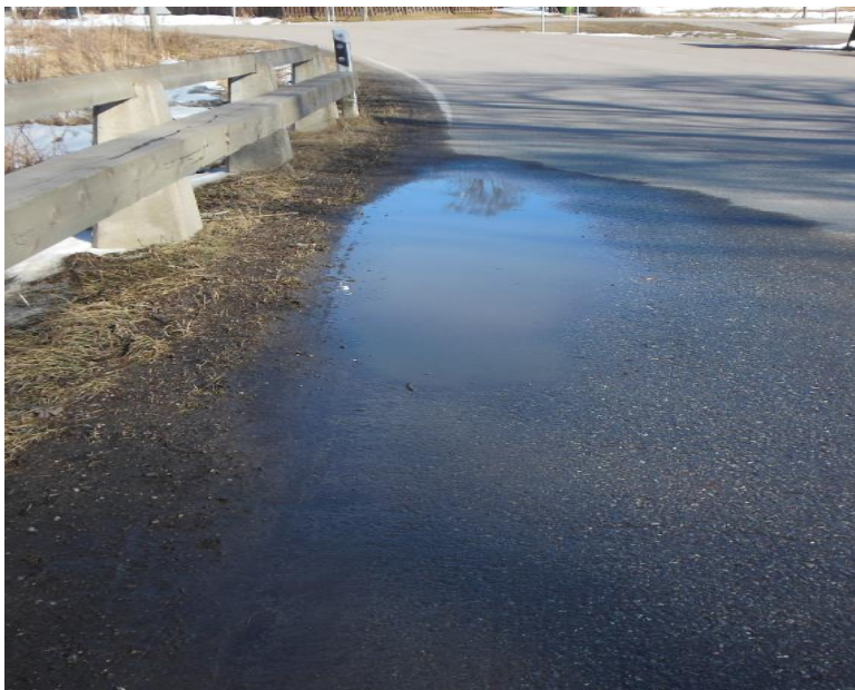
KUVA 39. Reunapalteen aiheuttamaa lammikoitumista (Kuva: Juha Poskiparta 2013).
