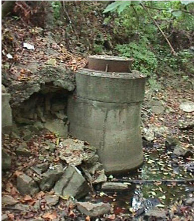
Kuva 1 Siirtynyt betoninen tarkastuskaivo /1/
