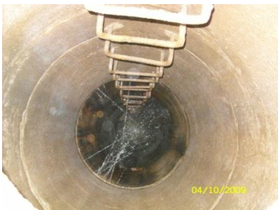
Kuva 3 Vuotoa betonisen tarkastuskaivon renkaiden välistä /2/
