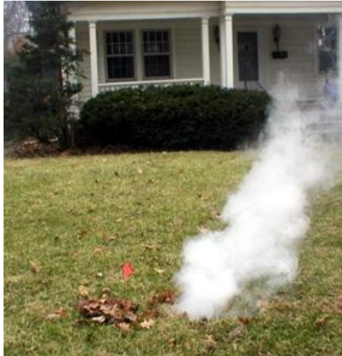
Kuva 5 Savukokeen paljastama vuotokohta /2/
