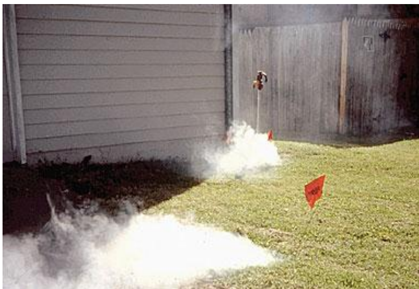
Kuva 9 Savun paikantamat viemäriin vuotokohdat (City of Oregon 2013b, www-sivut).
