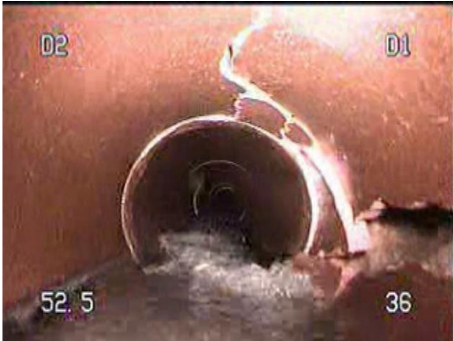
Kuva 7 Haljennut viemäriputki. (City of Oregon, 2013b, www-sivut)
