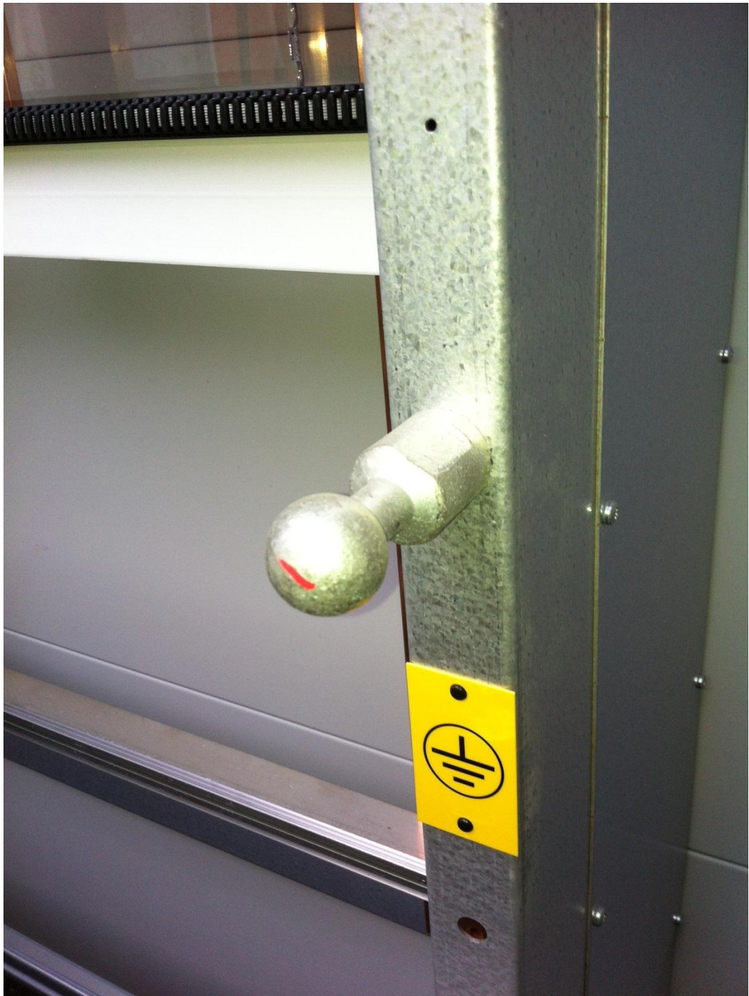
KUVA 3. Työmaadoitus välineiden liitoskohta puistomuuntamossa
