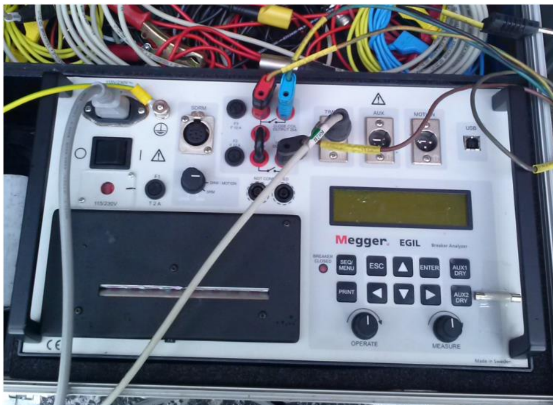
KUVA 14. Megger Egil katkaisija analysointilaitteella (valokuva Kalle Karhumaa.)
