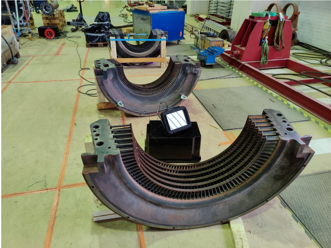
Kuva 26. Johtosiipikannakkeita/sisäpesiä irrotettuna pesistä turbiinialissa pyörrevirtatarkastusta varten.
