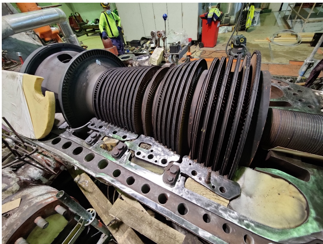
Kuva 24. Höyryturbiinirevisio. Valmistusvuosi 1976, teho 51,8 MW, 3000 rpm, höyryn paine 60 bar ja lämpötila 510 °C
