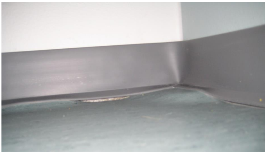
Figur 5. I hörnet har mattan fastnat i väggen och därför lossnat från golvytan. (Janne Nykänen)
