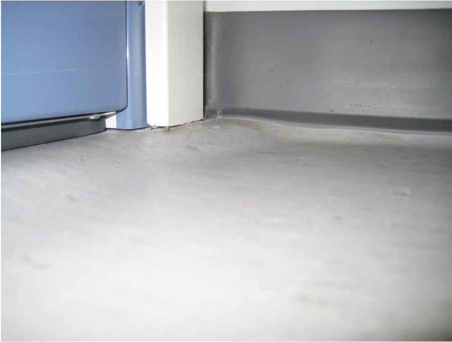
Kuva 18. Kuvassa näkyy miten lattia on laskenut selvästi alle valukoron. Vasemmalla sijaitsevan ovenaukon alapinta on lattian alkuperäinen korko. (Janne Nykänen)
