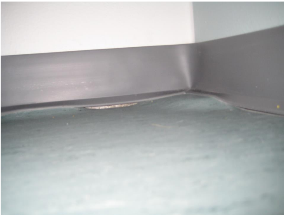
Kuva 19. Kulmassa muovimatto on kiinni seinässä ja lattia on painunut alas monta millimetriä. (Janne Nykänen)
