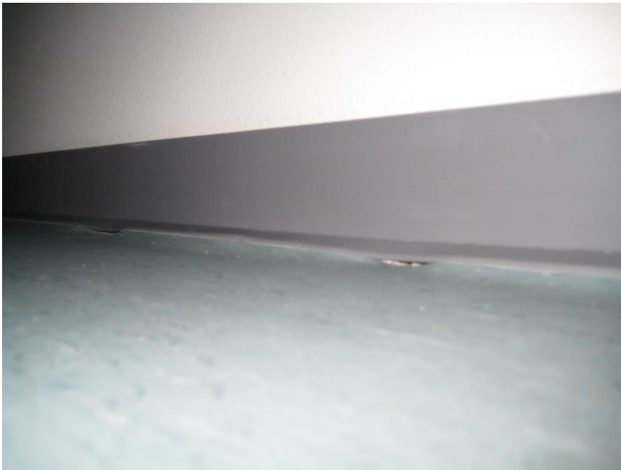
Kuva 17. Seinälinjan kohdalta painunut lattiapinta. (Janne Nykänen)
