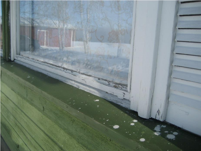
Kuva 1. Ikkunan pokat kaipaavat huoltoa
