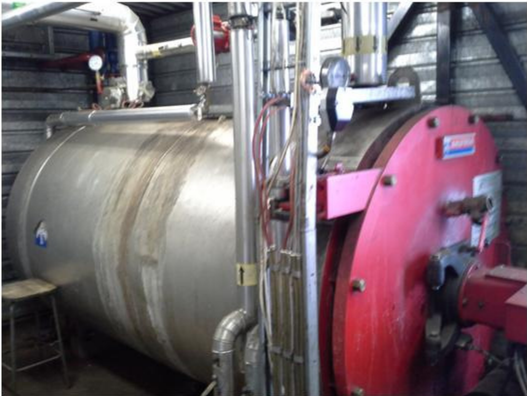
Kuva 11. Alakylän öljykattila (Tuomo Justander 2013).
