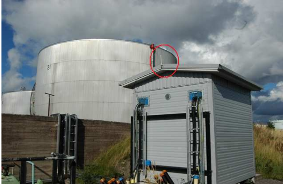
KUVA 28 Muuntamorakennus ja gatewayn antenni
