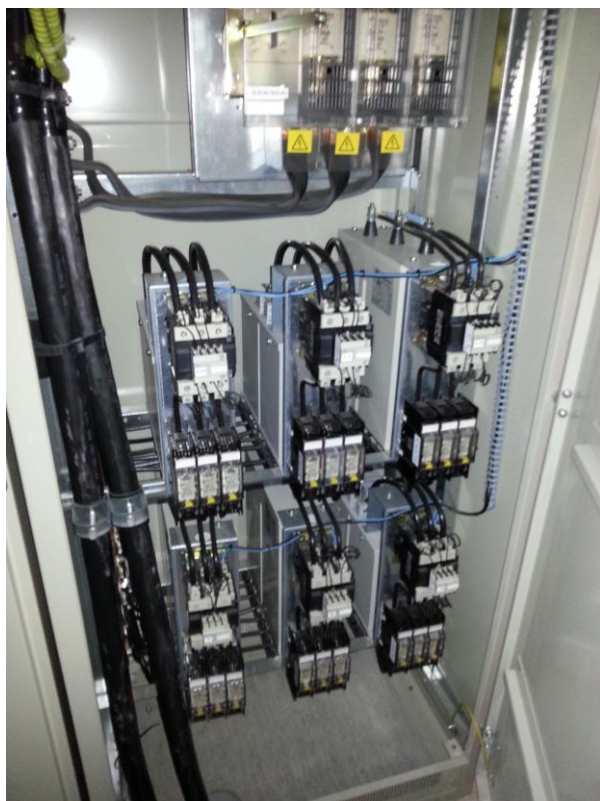
Kuva 1. Pääkeskuksen toisen pariston kondensaattorit
