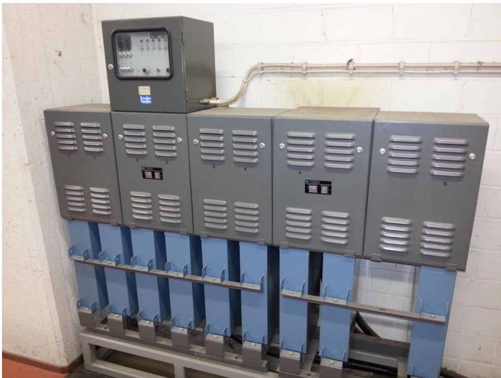
Kuva 2. Uuden tehtaan pääkeskus
