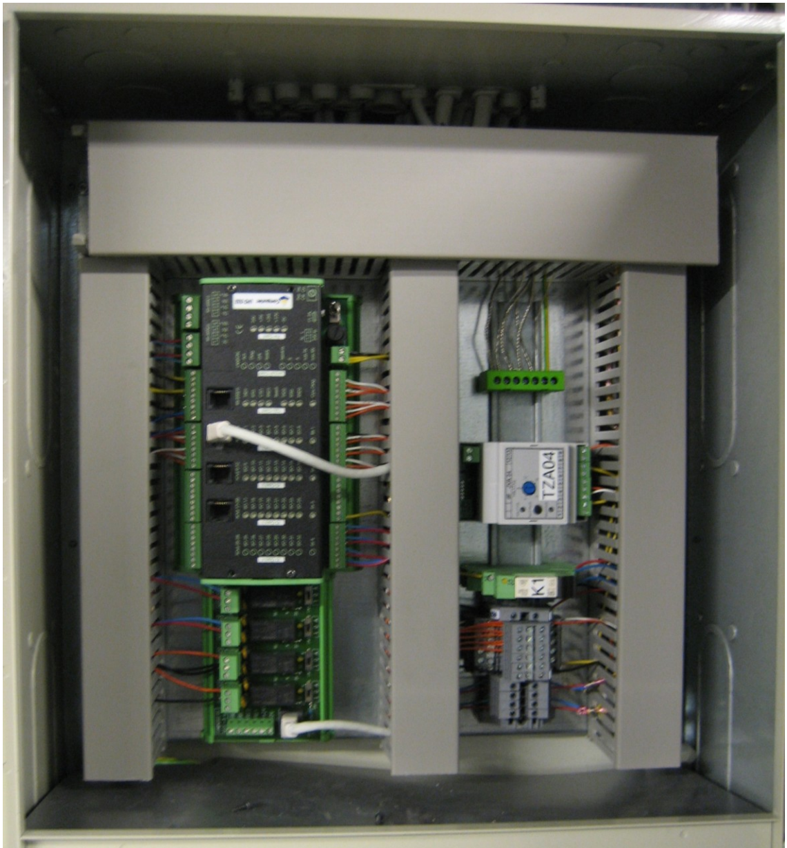
Kuva 3. Computecin ohjausyksiköllä toteutettu ilmankäsittelykoneen ohjaus
