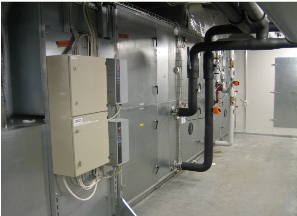
Kuva 2. Ilmankäsittelykone kaapeloituna ja instrumentoituna
