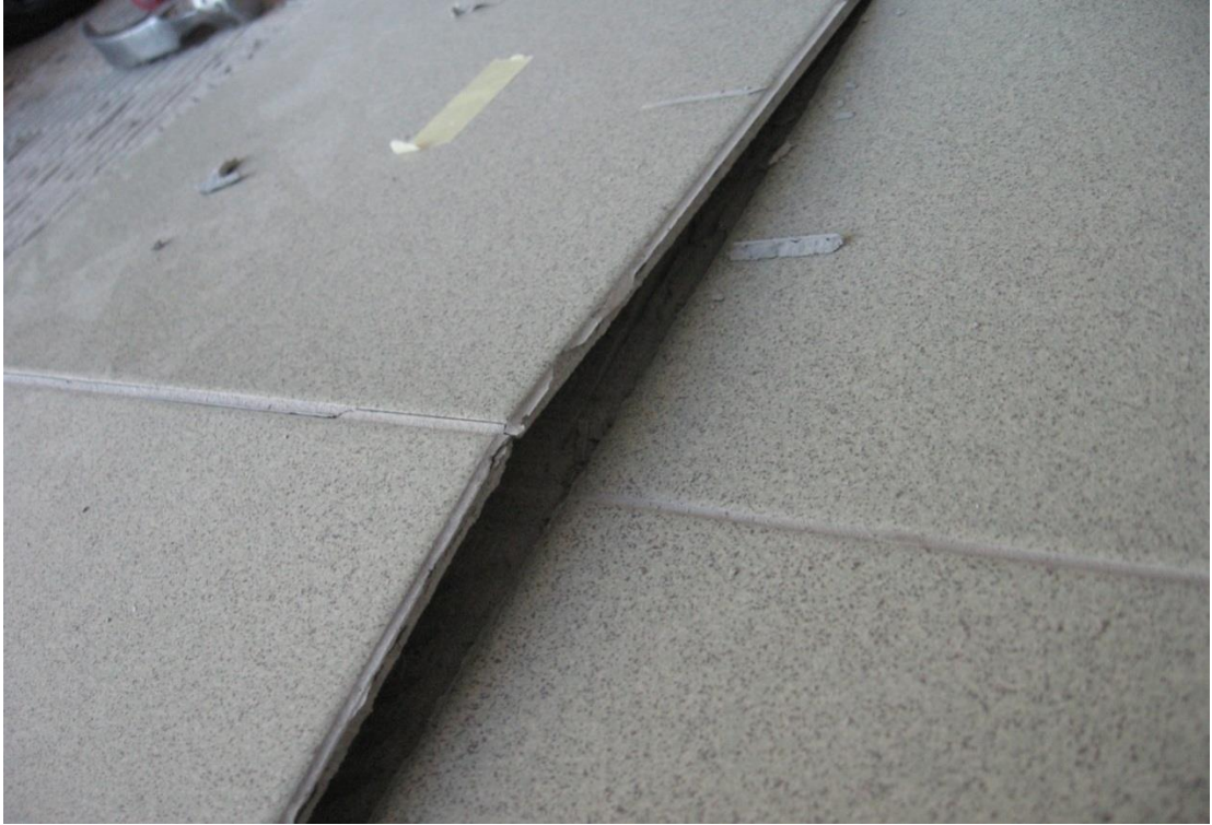
Kuva 7. Laatoitus on irronnut ehjänä (M. Saarikko, henkilökohtainen tiedonanto 24.4.2013).
