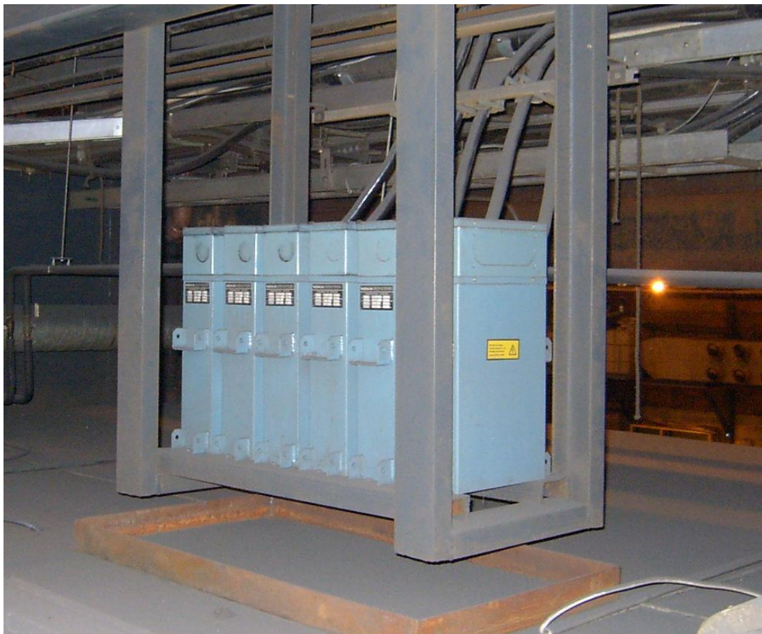
Kuva 9. Muuntamon M2 alkuperäiset 5·40kvar kondensaattoriparistot. (Kuvaaja Petri Raukola)
