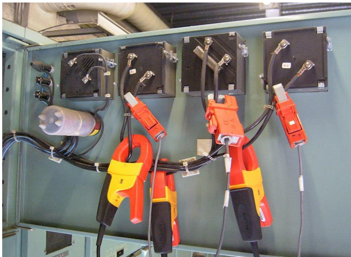
Kuva 4. Virtapihdit kiinnitettyinä suoraan virtamittareiden johtimiin, muuntamo M6. (Kuvaaja Petri Raukola)
