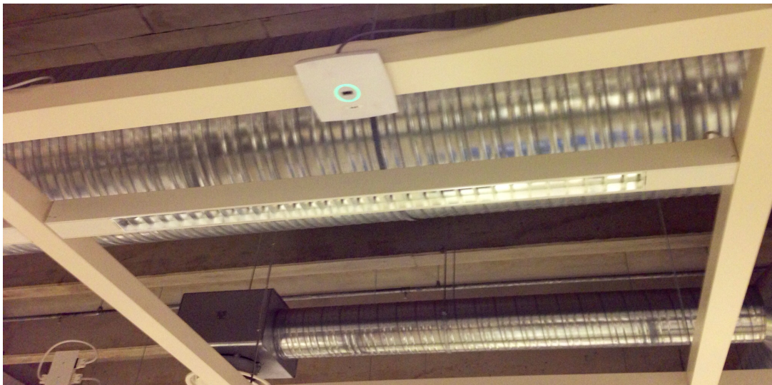
Kuva 21. Kuva toteutuneesta asennuksesta. Huomaamattomuudesta kertoo paljon se, että asiakastiloissa kiertäessä on vaikea löytää tukiasemia, vaikka tietää niiden olevan siellä ja tietää paikat suurin piirtein.
