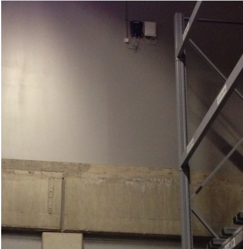
Kuva 19. Kuva toteutuneesta asennuksesta korkeavaraston takaseinältä.
