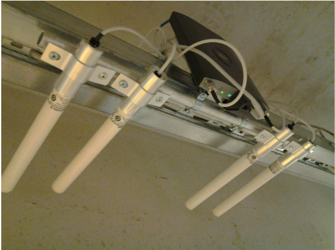
Kuva 17. Tässä on kuva lopullisesta asennuksesta.
