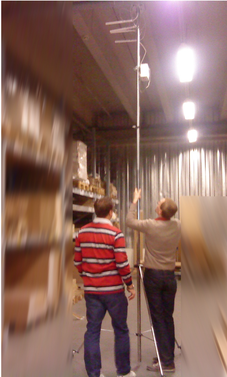
Kuva 13. Unisys'in työntekijät virittämässä testiantennia Pre-Site Surveyta varten. Mittausta tehdessä on otettava huomioon antennien todellinen asennuskorkeus, jotta mittaus vastaisi mahdollisimman tarkasti todellisuutta.
