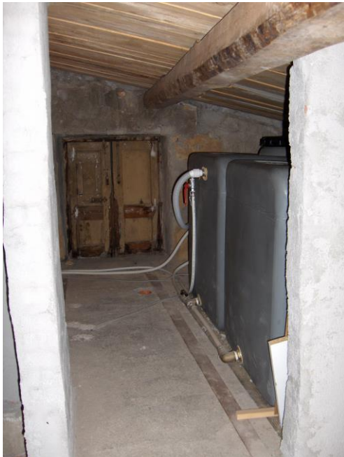
Kuva 1. Vesisäiliö rakennuksen ullakolla [1].
