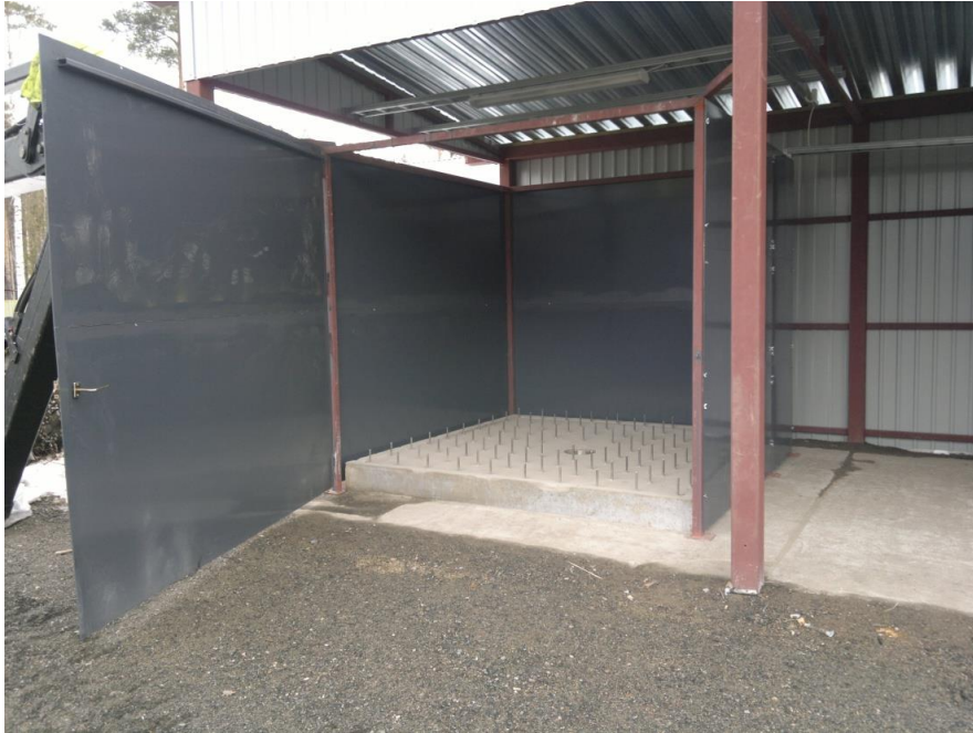
Kuva 11. Teräslevyillä suojattu testitila (Kuva: Markku Hiltunen).
