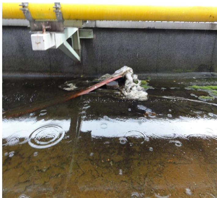
Kuva 8. Tukkeessa oleva kattokaivo
