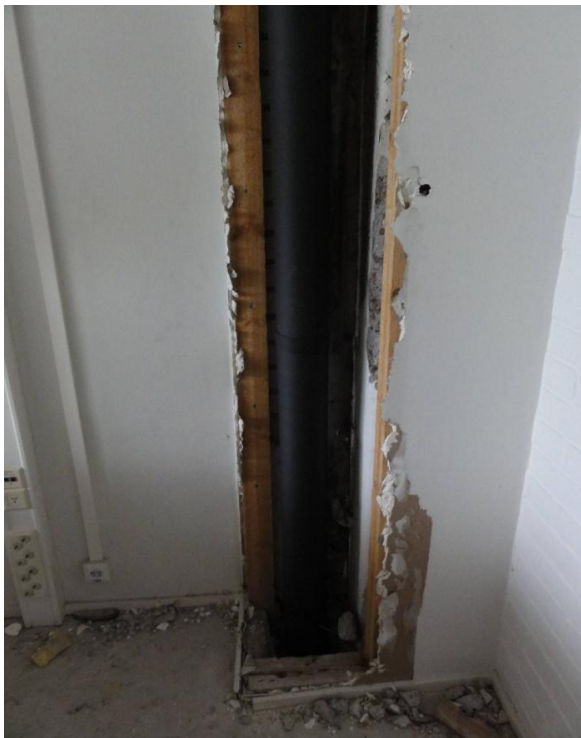
Toimiston uusi eristetty teräsputki.
