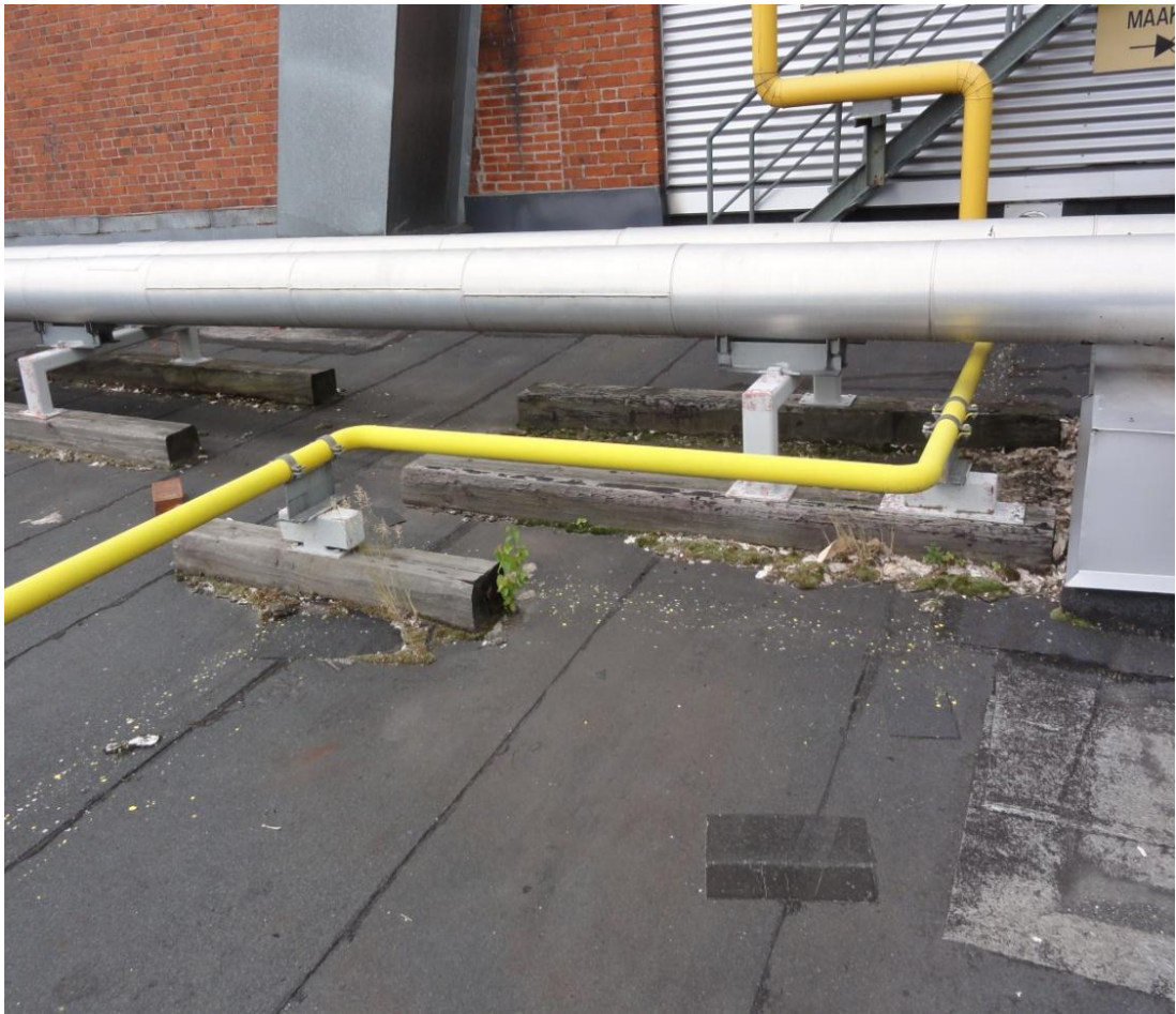
Kaasuputken tukipilarit estävät veden valumisen sadevesiviemäriin.
