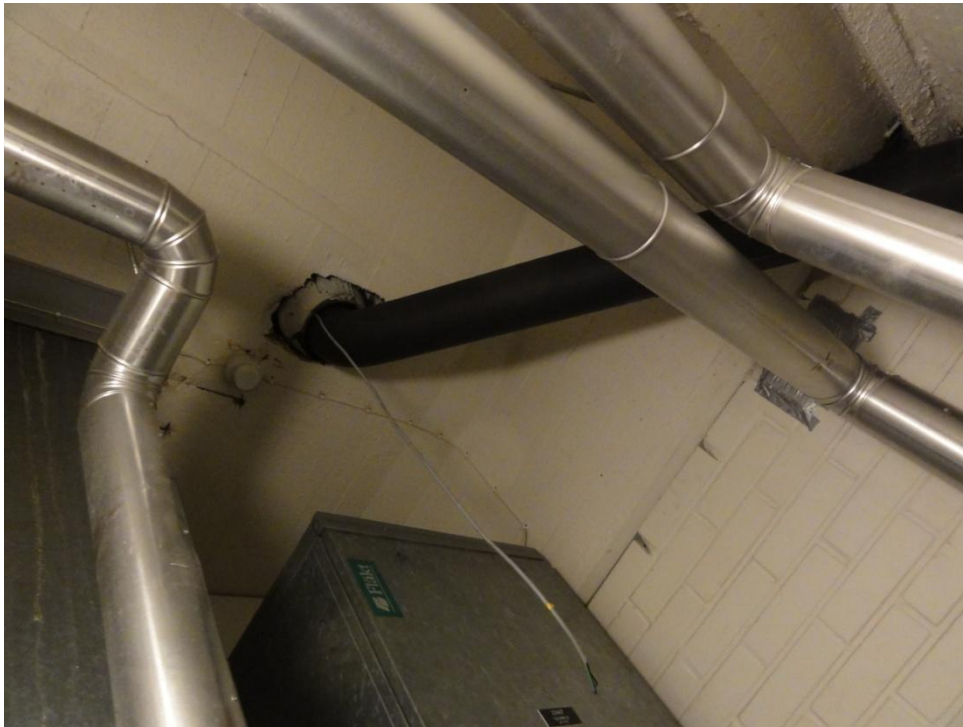
Kuva 12. Varastohuoneen uusi eristetty teräsputki, josta lämmitettävän kattokaivon sähköjohto on asentamatta.
