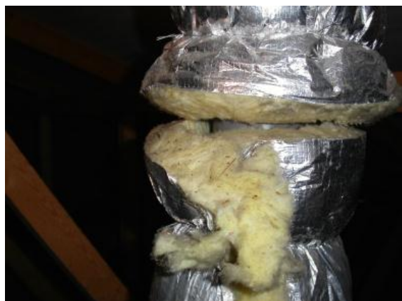
Figur 14. Bristfällig isolering av ventilationsrör på kallvind (Kosteus – ja hometalkoot u.å.).
