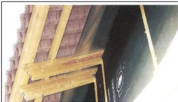
Figur 28. Underlagstakets kant är tydligt utanför väggens kommande beklädnad. (Miljöministeriet 2009).
