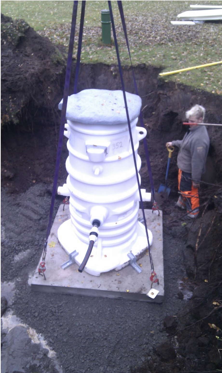
Kuva 19. Pumppaamo murskearinan päällä
