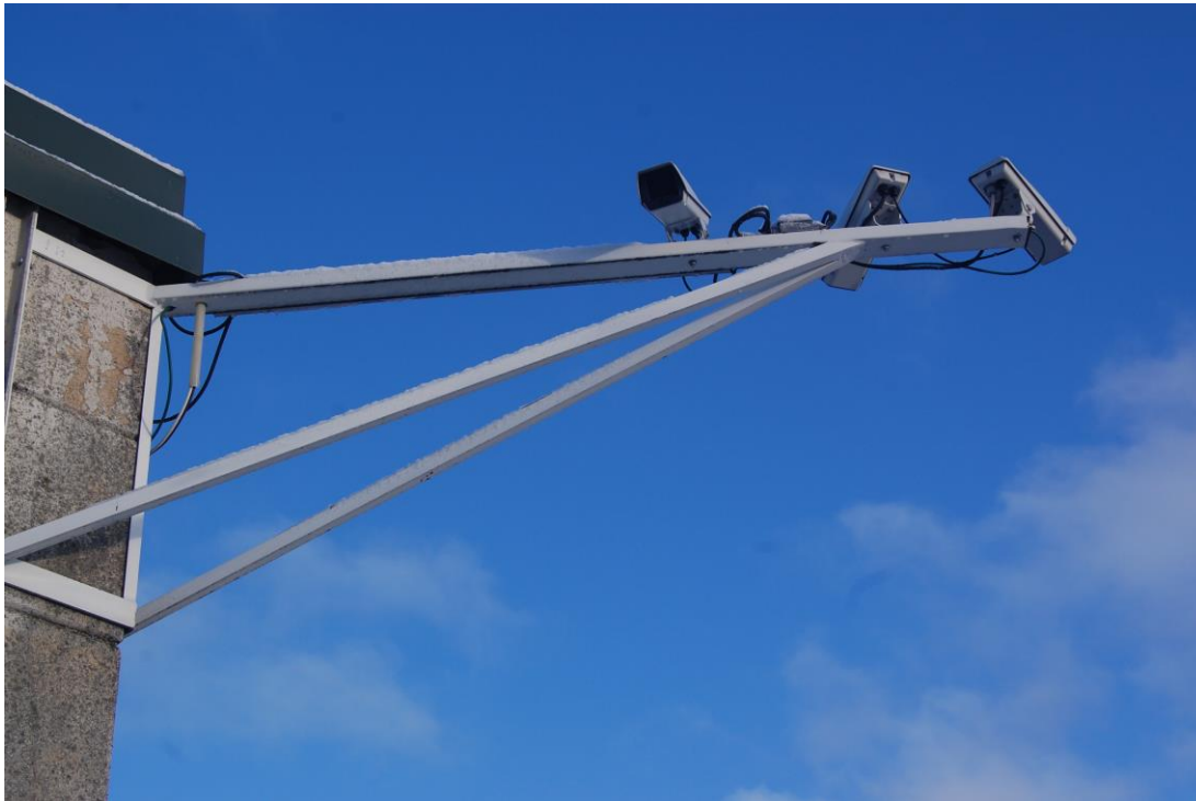
Kuva 8. Valvontakameroita rakennuksen nurkalla pääsisäänkäynnin oikealla puolella. (Hämäläinen 2013)
