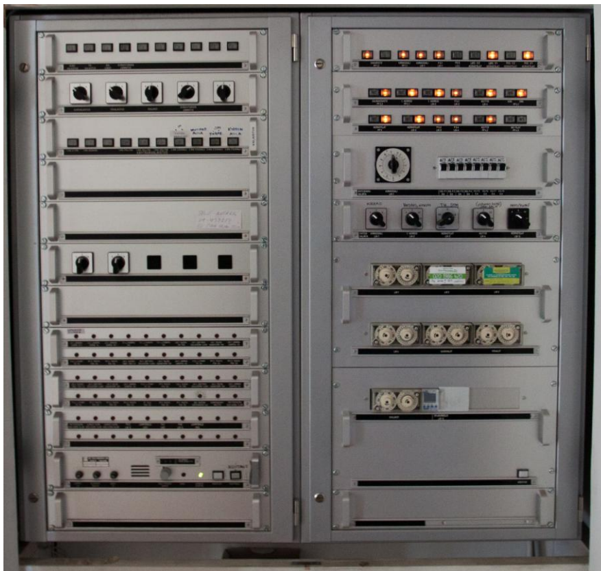
Kuva 7. Myyrmäen kirkon rakennusautomaatiojärjestelmän valvomo
