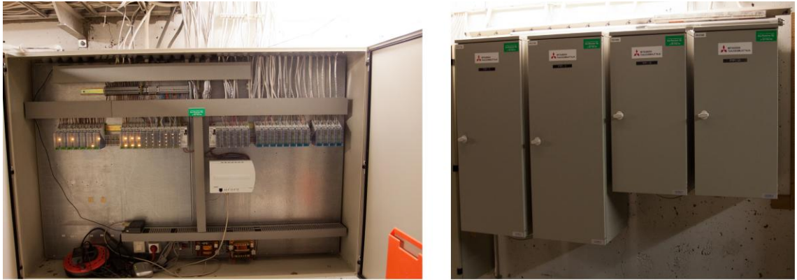
Kuva 25. VAK1-alakeskus ja taajuusmuuttajakeskukset
