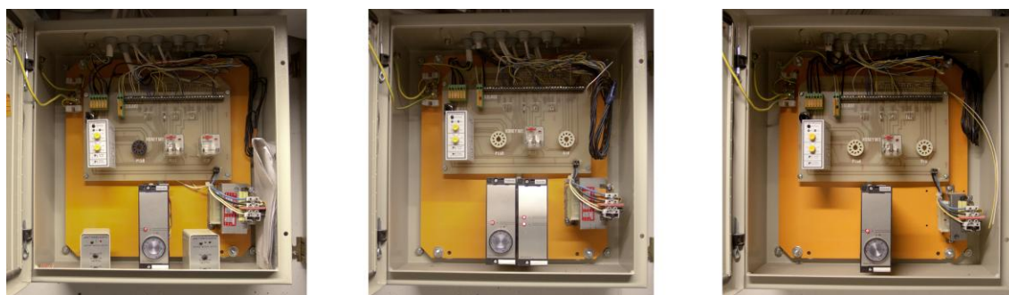
Kuva 28. TK1, TK2 ja TK3 säätölaittekeskukset
