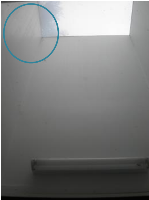
Kuva 3. Tiivistyneen kosteuden aiheuttamia valumajälkiä valokuilussa (4)
