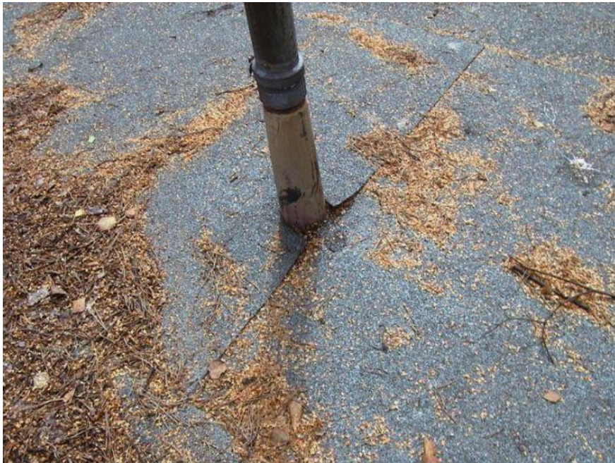
Kuva 2. Huonosti toteutettu läpiviennin vedeneristys (2)
