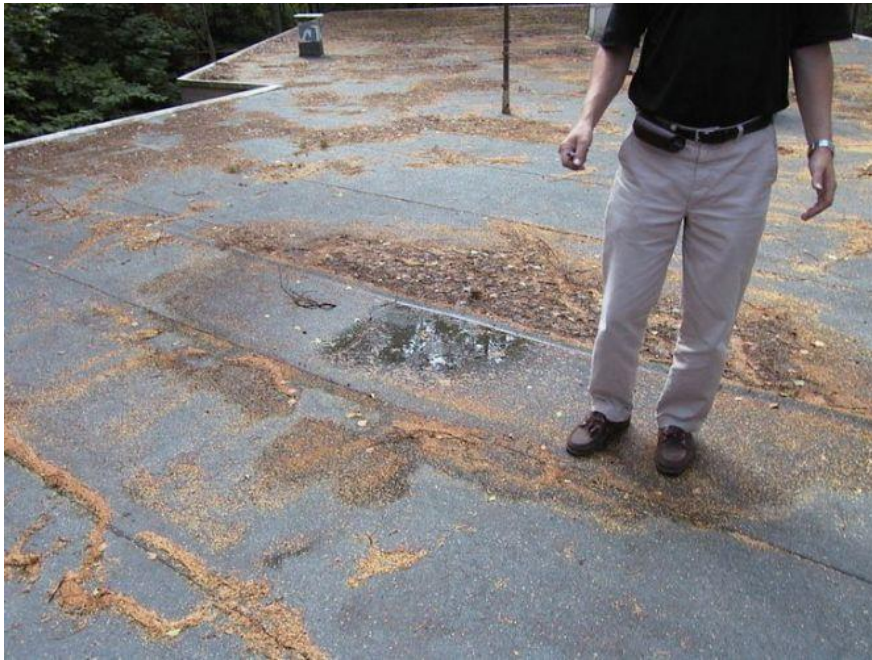
Kuva 1. Rakenteiden painumisesta johtuva lammikoituminen katolla (2)
