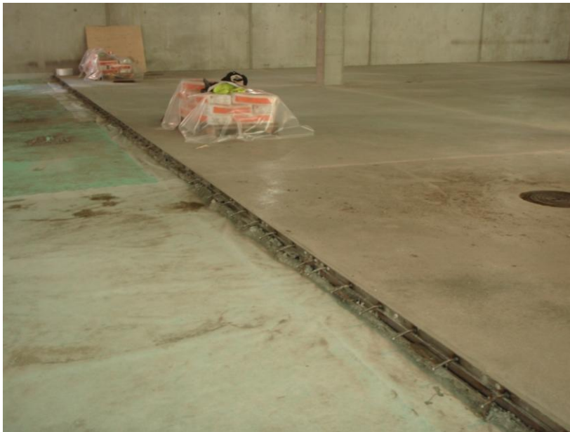
Kuva 30. Kuvassa on esitetty Swing Plus C-talon alimman autohallin sirotepinnoitettu maanvarainen laatta. Liikuntasauva toimii samalla myös työsaumana.
