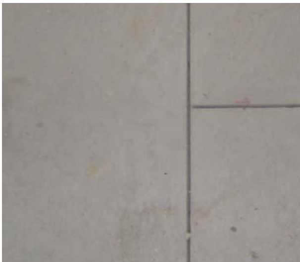
Kuva 21. Swing Plus C-talon sirotepinnoitetun betonilaatan sahattu kutistumissauma.
