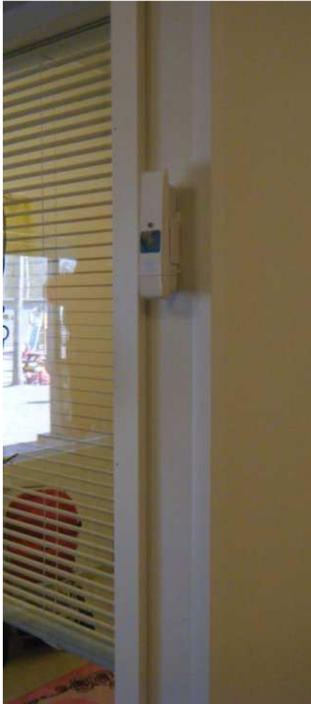
Kuva 4 Ryhmän 2 ryhmähuoneen seinään asennettu langaton Wirepas-mittari.
