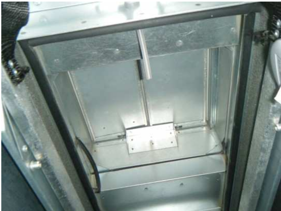
Kuva 12 Ilmanvaihtokone tukittu laitteen omalla sulkupellillä.
