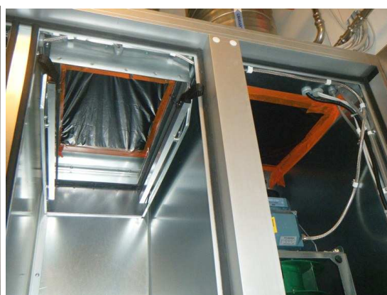
Kuva 3. Ilmastointikoneen sisäilman tulo- ja poistokanavat tukittu teippaamalla
