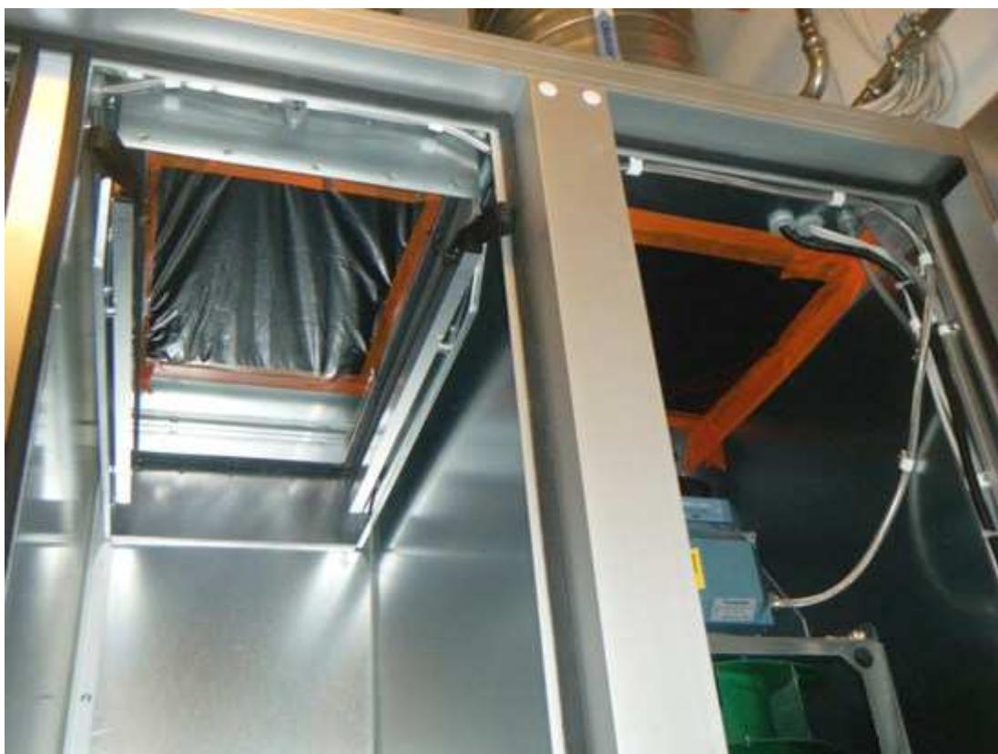
Kuva 11 Ilmanvaihtokone tukittu teippaamalla.
