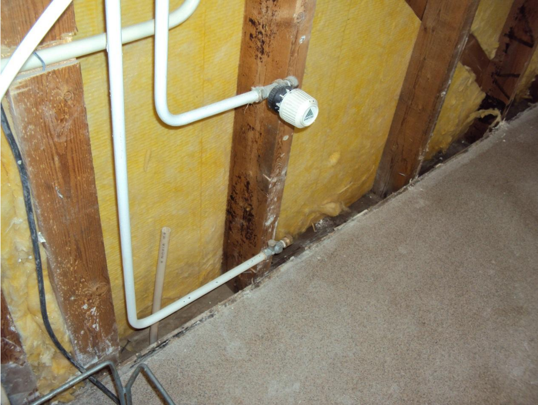
Kuva 13. Kostuneet ja homevaurioituneet runkotolpat. Kuva Harri Hiekkänen 2013.
