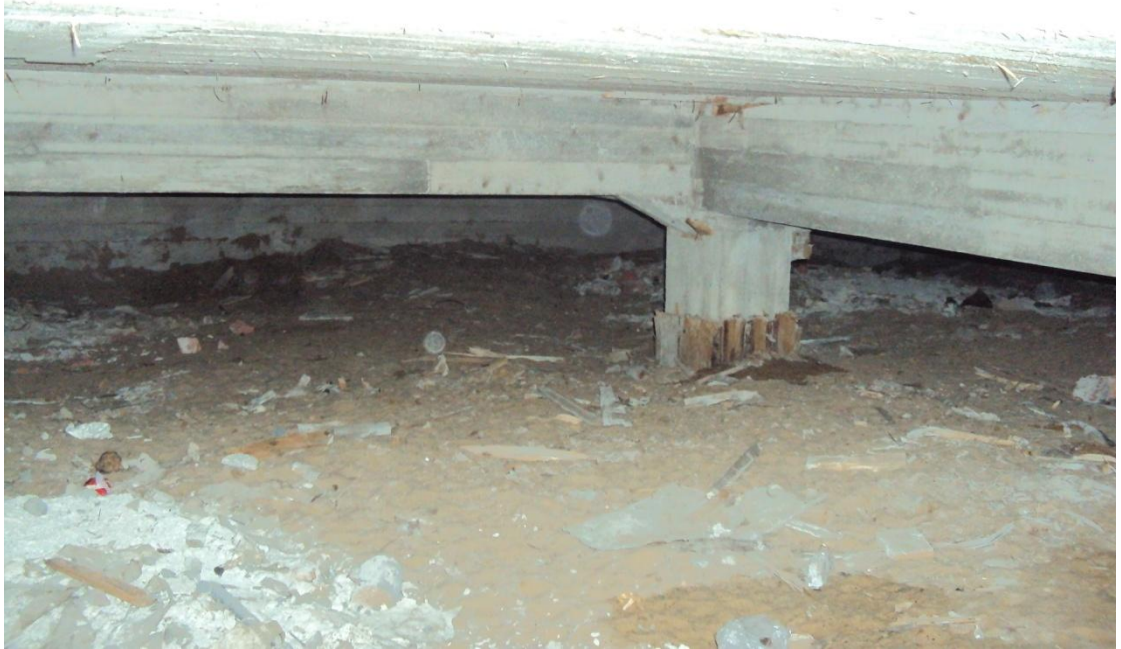
Kuva 21. Ryömintätilan ongelmat. Kuva Harri Hiekkänen 2013.
