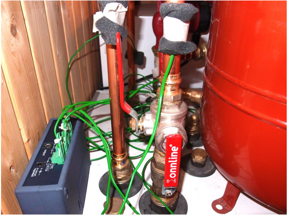
Kuva 12. Puskurivaraajan lämpötilan mittaus
