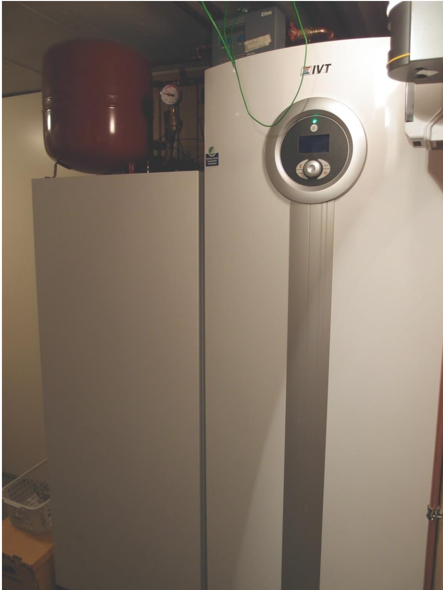
Kuva 9. Maalämpöpumppu ja ulkoinen puskurivaraaja.
