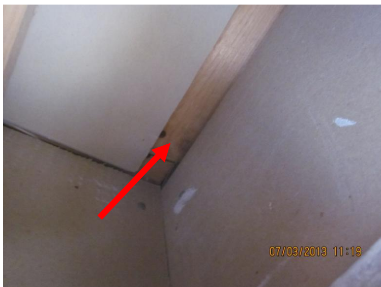
KUVA 6. Huoneen B10 vaillinainen höyröysulku ikkunakotelossa (Räsänen 2013).
