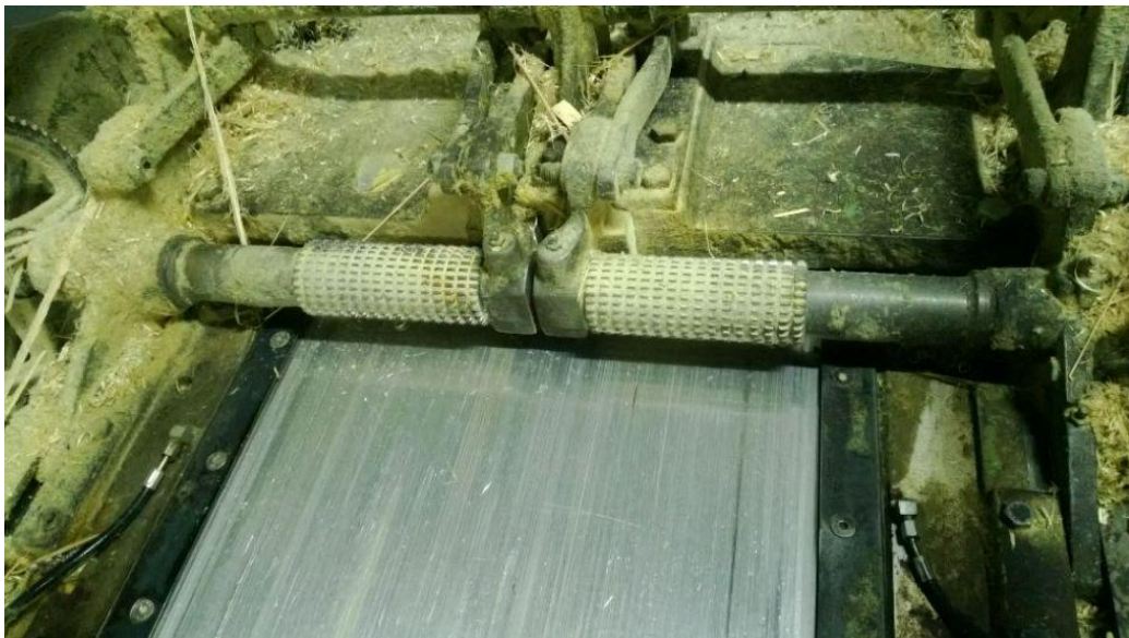
Kuvio 8. Höyläkoneen kohta, josta tulipalo sai alkunsa.
