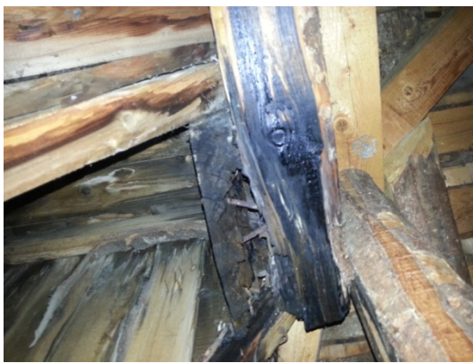
Kuvio 13. Vuotojen aiheuttama lahovaurio kantavassa rakenteessa
