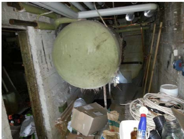
Kuvio 33. Lämminvesivaraajan rikkoutunut eriste
