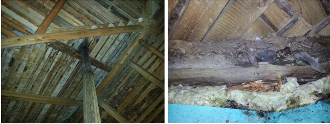
Kuvio 9 a ja b. Viemärin läpivienti ja sen vuodosta aiheutunut lahovaurio
