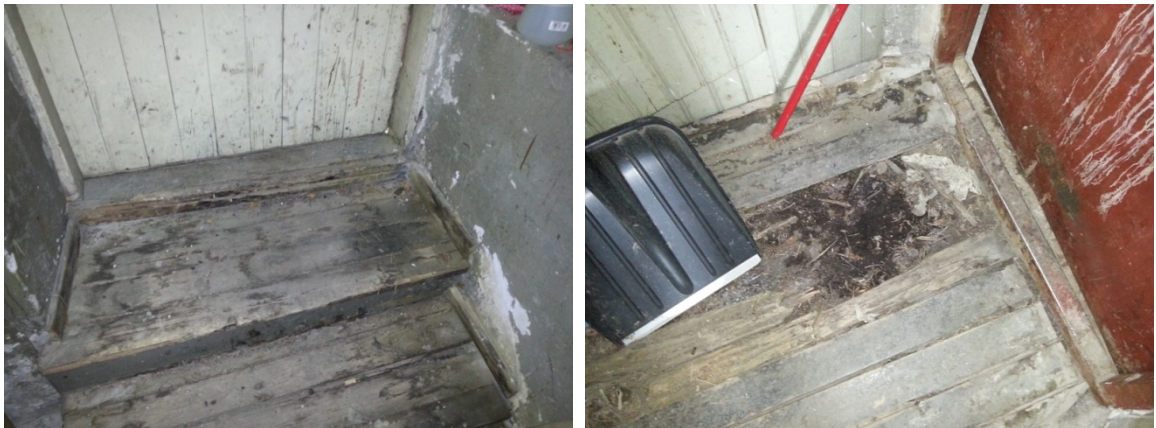
Kuvio 27 a ja b. Kellarin toisen sisäänkäynnin kosteusvaurioista kärsineet portaat ja lattia
