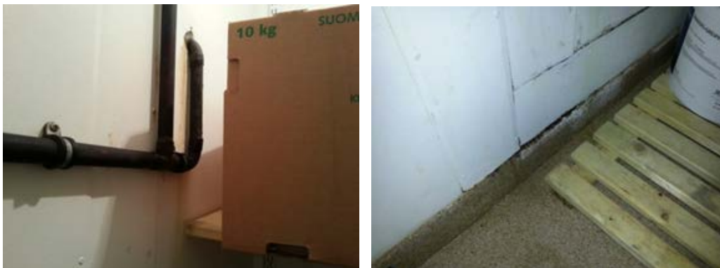
Kuvio 6 a ja b. Kylmiön kondenssivesiputken valumat rakenteisiin.
