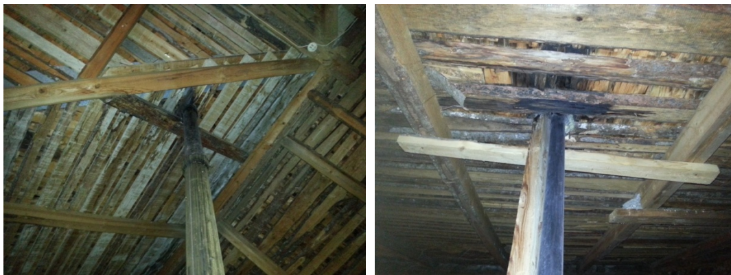
Kuvio 9 a ja b. Lämpivientien vuotoja ja eristämätön viemärin tuuletusputki
