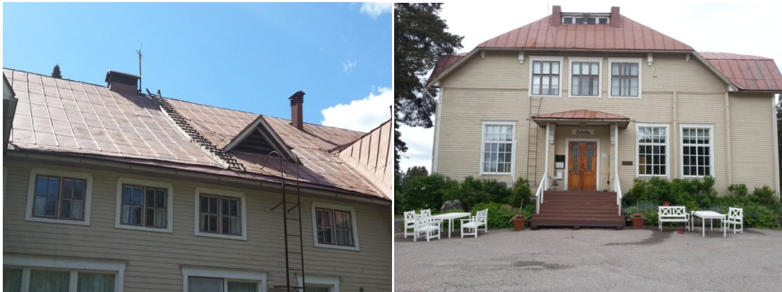
Kuvio 37 a ja b. Kulkuaukkojen kohdilta puuttuvat lumiesteet
