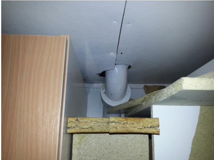
Kuvio 34. Toisen kerroksen varastossa olevan viemärin läpivientikohdassa oleva vesivaurio
