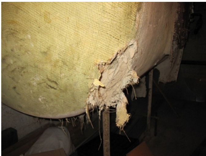
Kuvio 11. Lämminvesivaraajan rikkoutunut asbestieriste
