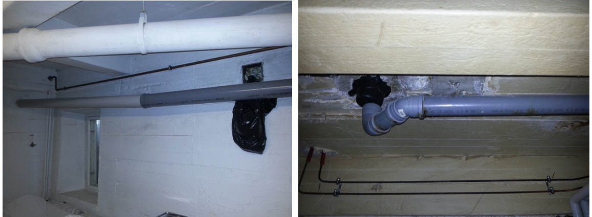
Kuvio 32 a ja b. Kannakoimattomia viemäriputkia kellaritiloissa
