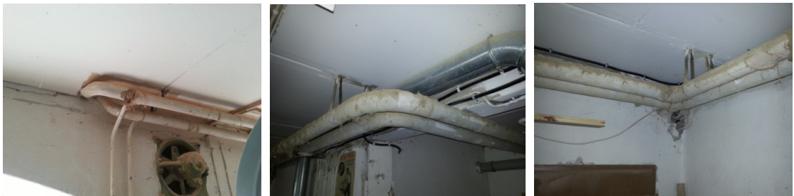
Kuvio 35 a, b ja c. Kellarin rikkonaisia putkieristeitä
