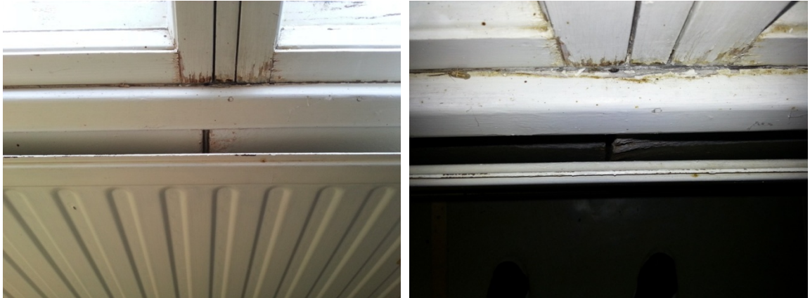
Kuvio 17 a ja b. Nykyisen kuivaushuoneen ikkunan alapuolinen kosteusvaurio
