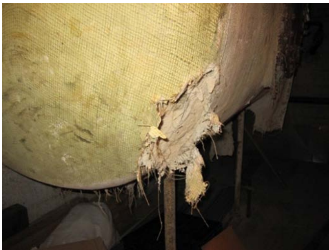
Kuvio 36. Lämminvesivaraajan rikkoontunut eriste
