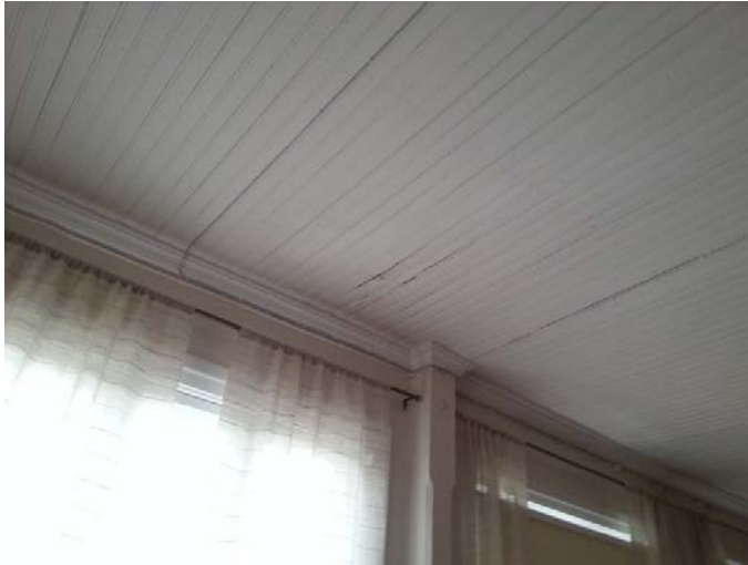
Kuvio 19. Kokoustila Kankaalan katossa oleva vesivaurio
