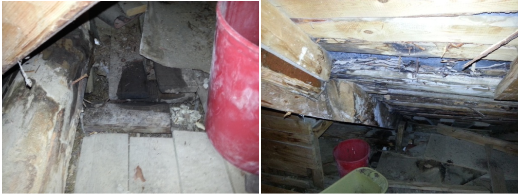
Kuvio 12 a ja b. Vuodoista aiheutuneita vaurioita
