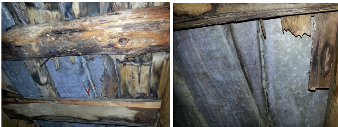
Kuvio 11 a ja b. Silikonilla paikattuja vesikaton vuotokohtia
