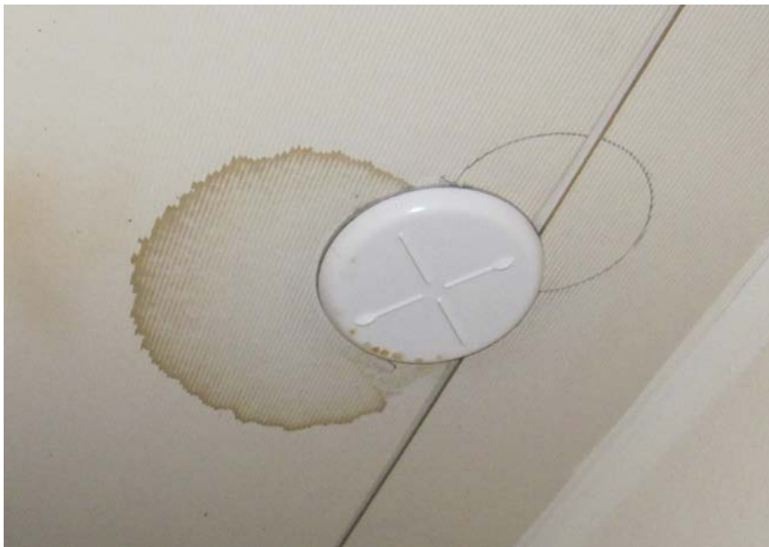
Kuvio 10. Puutteellisesti tiivistetyn läpiviennin aiheuttama kosteusvaurio
