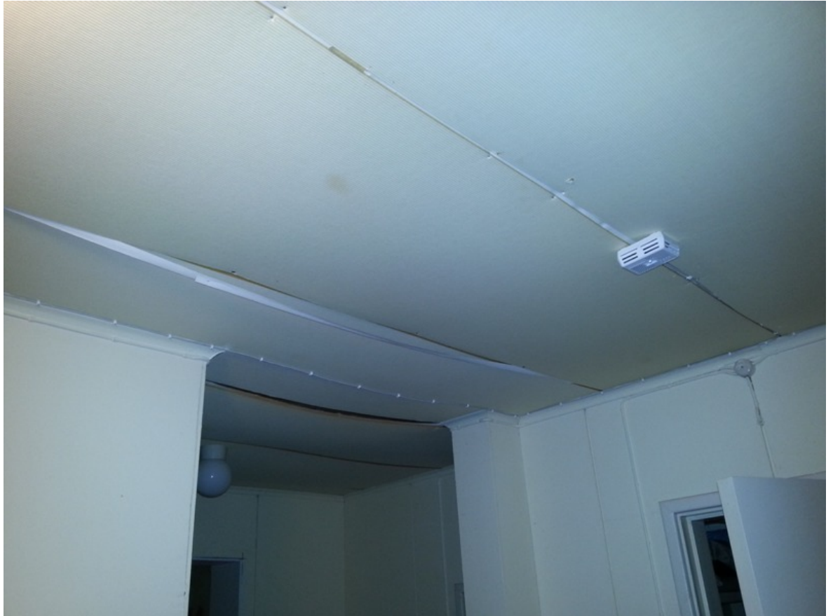
Kuvio 21. Toisen kerroksen käytävän irtonaiset kattoverhouslevyt
