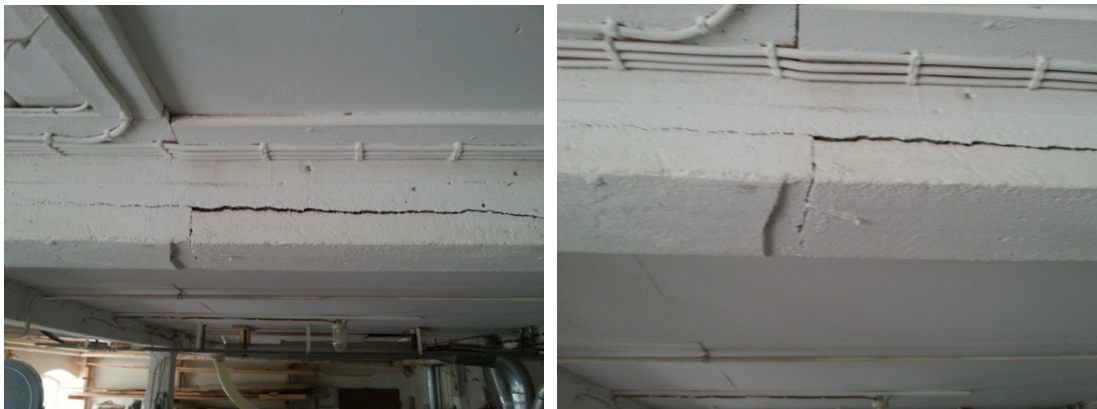
Kuvio 31 a ja b. Veistosalin haljennut betonipalkki
