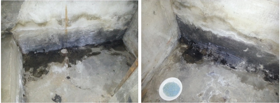
Kuvio 28 a ja b. Vanhassa säilytyskellarissa olevia kosteusvaurioita
