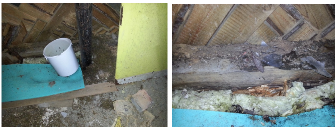
Kuvio 10 a ja b. Tuuletusviemärin läpiviennin vuodoista tulleita vaurioita
