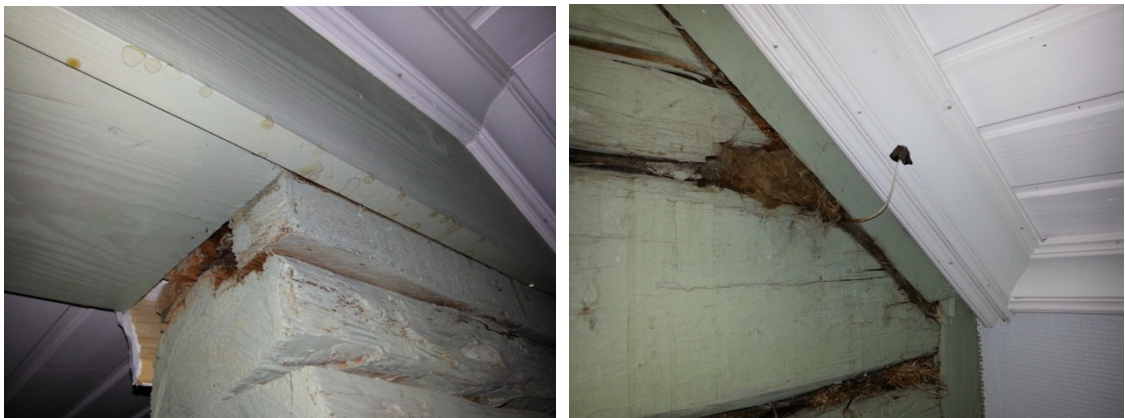
Kuvio 18 a ja b. Körttimuseon opistot osalla olevan väliseinän lahovaurioita
