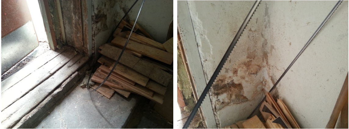
Kuvio 30 a ja b. Veistosalin kosteusvaurioista kärsinyt sisäänkäynti
