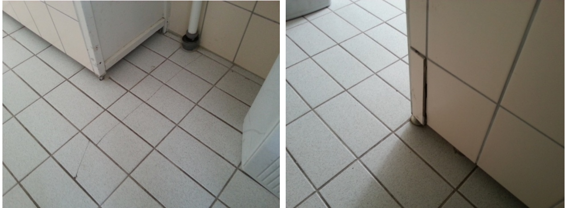
Kuvio 24 a ja b. Naisten WC:n lattian haljenneet laatat sekä kevyestä väliseinästä irronnut laatta
