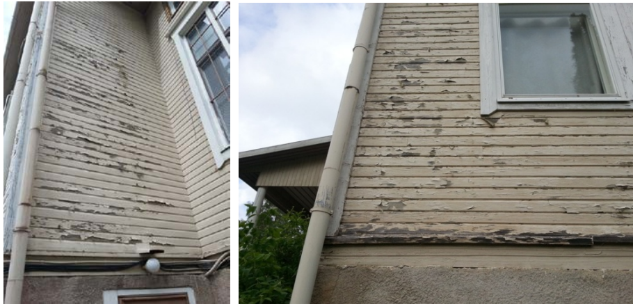
Kuvio 7 a ja b. Julkisivun maalivaurioita
