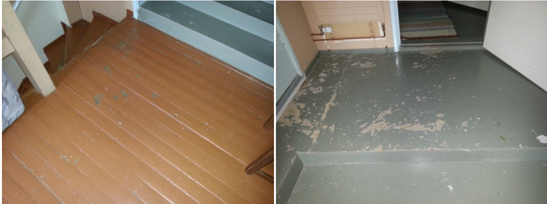
Kuvio 22. Toisen kerroksen eteisen lattiapinnan maalivaurioita ja painuma WC:n edessä
