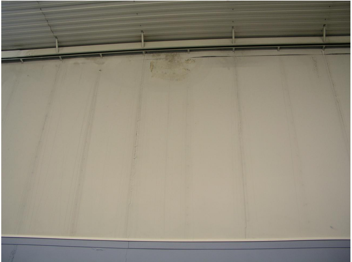
KUVA 15. Kosteusvaurio. (Alanen & Saviahde 2013)
