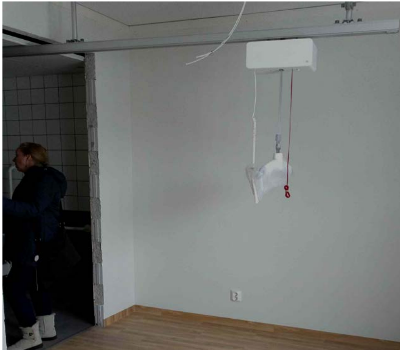
KUVA 2: Kattokiskoon asennettu henkilönostin uudisrakennuksessa. Kiskon avulla asiakas voidaan siirtää vuoteesta pyörätuoliin ja myös huoneensa WC-suihkutilaan.
