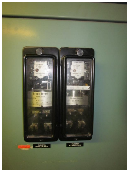
KUVA 15. Vanhan DC-keskuksen akuston maasulku- ja alijännitereleistys (valokuva Juha Heiskanen.)
