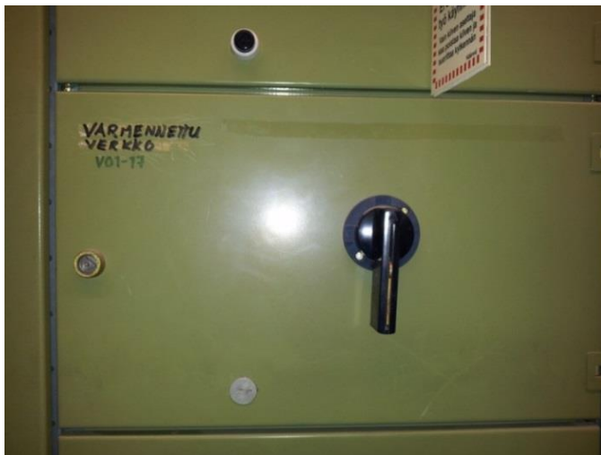
KUVA 4. Normaali sähkönsyöttö keskukselta VLC2.26 (valokuva Juha Heiskanen.)
