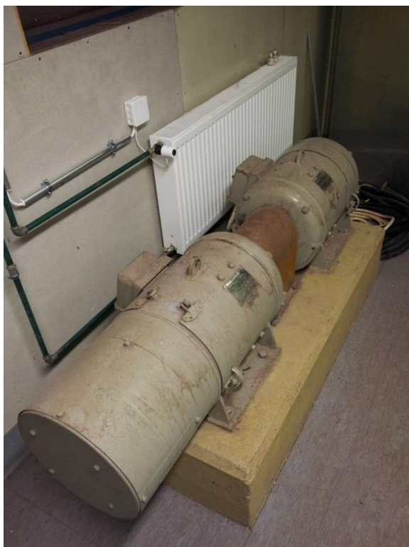
KUVA 3. Varmennetun sähkönsyötön varavoimakone (valokuva Juha Heiskanen.)
