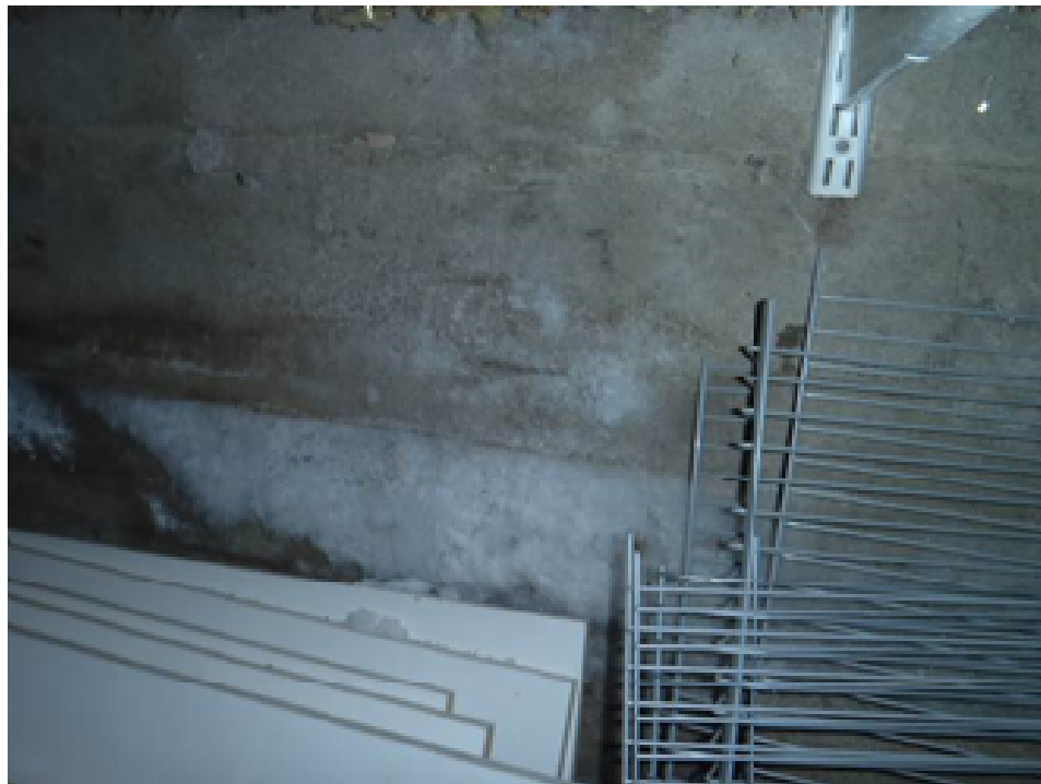
Kuva 8. Kellarin seinässä on härmää
