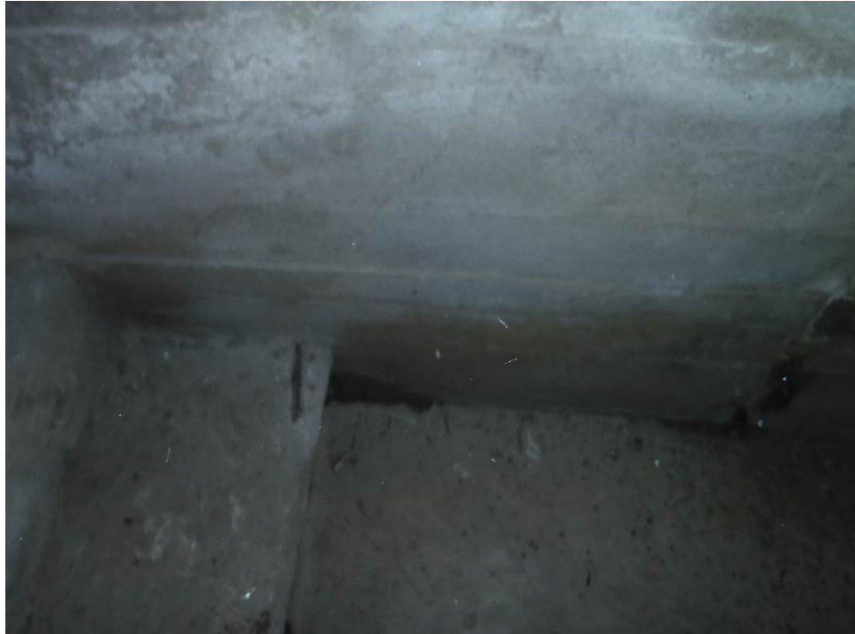
Kuva 9. Kellarin seinässä on jälkiä kosteusrasituksesta
