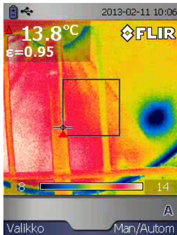
Kuva 25. Lämmönsiirtimen lämpötilajakauma raitisilmapuolelta
