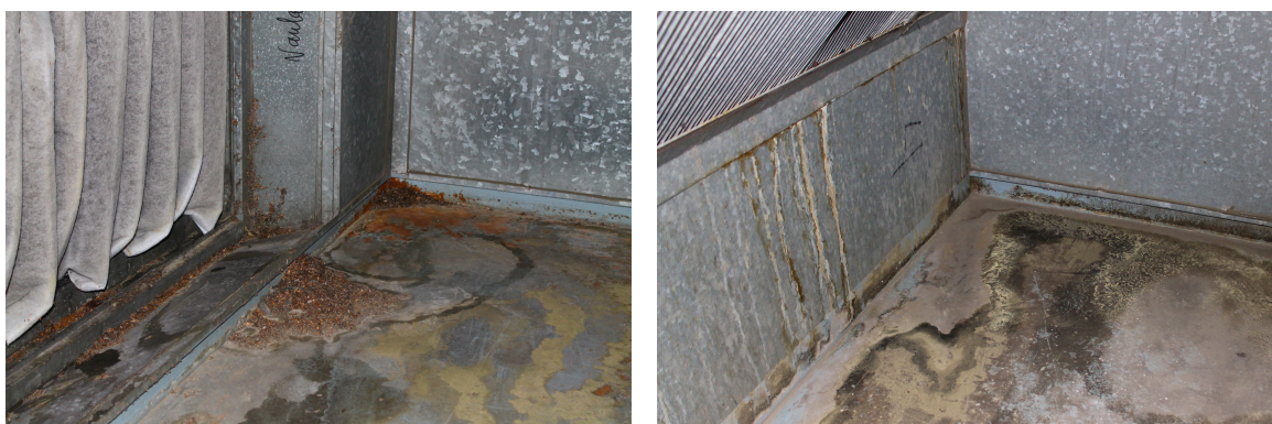
Kuva 24. (vasen) 5 TK/PK tuloilma ennen LTO:ta (oikea) 6 TK/PK poistoilma LTO:n jälkeen
