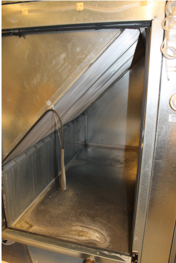
Kuva 26. Levylämmönsiirtimen tiivisteet ovat huonossa kunnossa. Kuva Elina Järvelä
