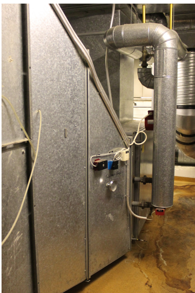
Kuva 13. 4 TK/PK:n kanavan levennys ja kiinteän lämpömittarin paikka
