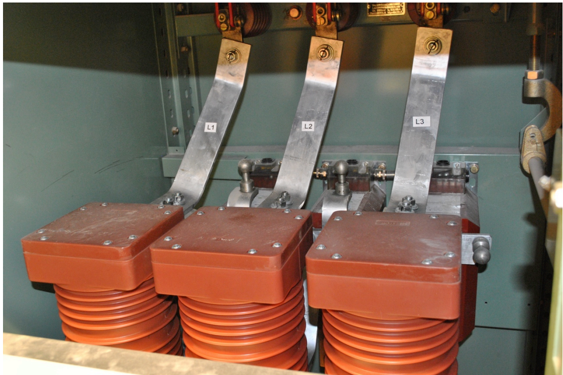
KUVA 9. Kiskomuutokset virtamuuntajien yläpuolisella osalla.
