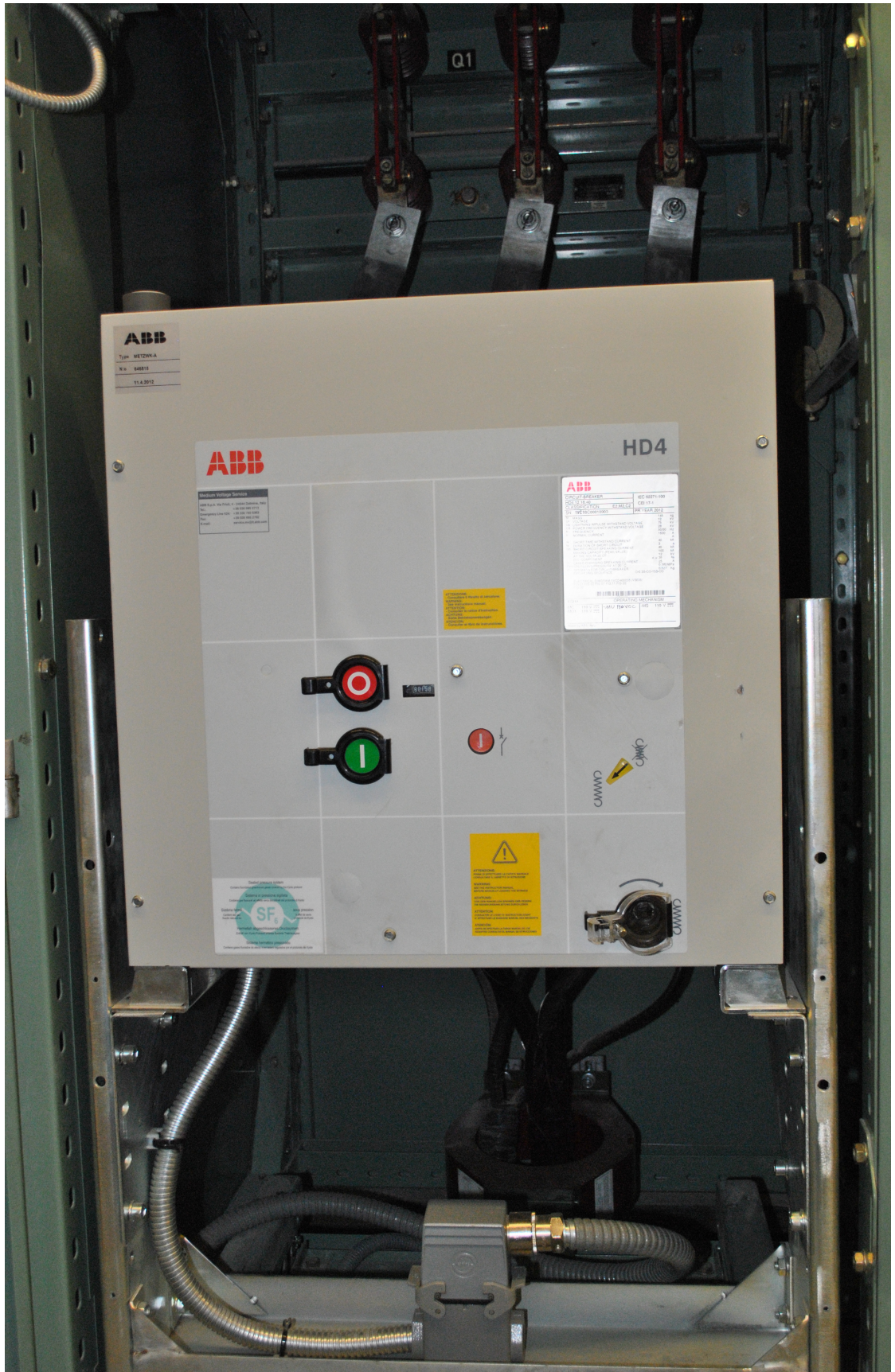
KUVA 10. HD4-katkaisija sovitevaunussa MEKA-kojeistoon asennettuna.
