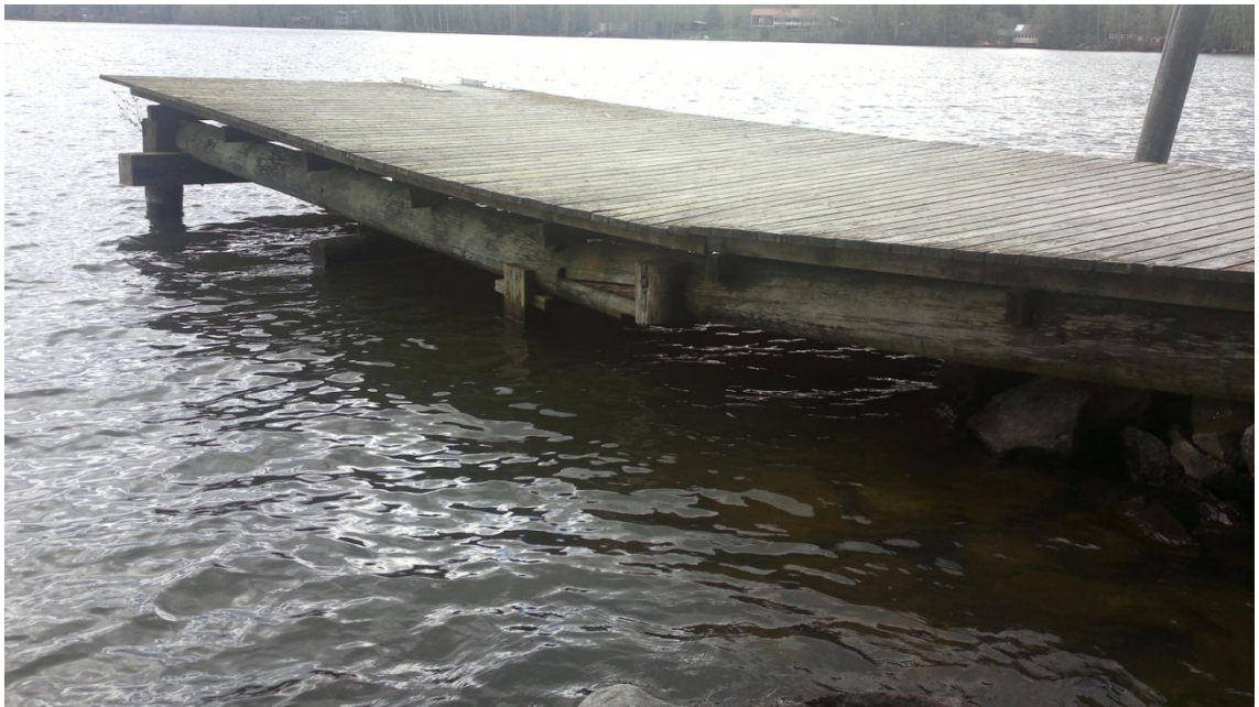
KUVA 16. Nykyisen laiturin kunto ja hätäratkaisuna lisätty puinen tuki laiturin keskellä olevassa halkeamakohtassa
